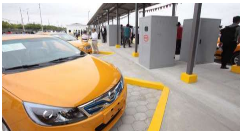
Figura 5.2: Electrolinera de Guayaquil de 1 megavatio de potencia instalada
