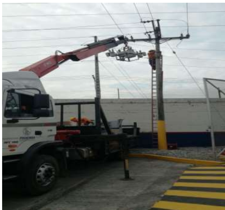
Anexo 3: Instalación de capacitores 3x200KVAR ramal Expandido.
