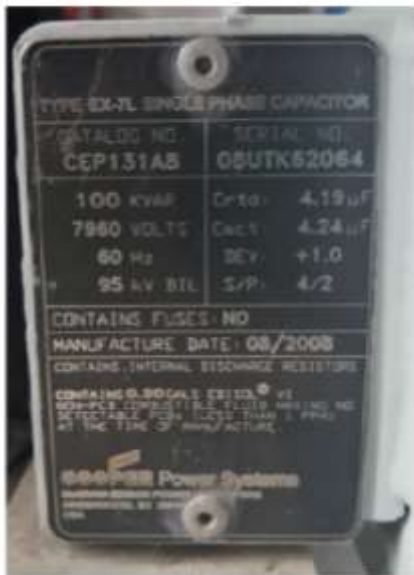
Ilustración 28: Datos de placa de banco de Capacitores 200KVAR Elaborado por Autor
