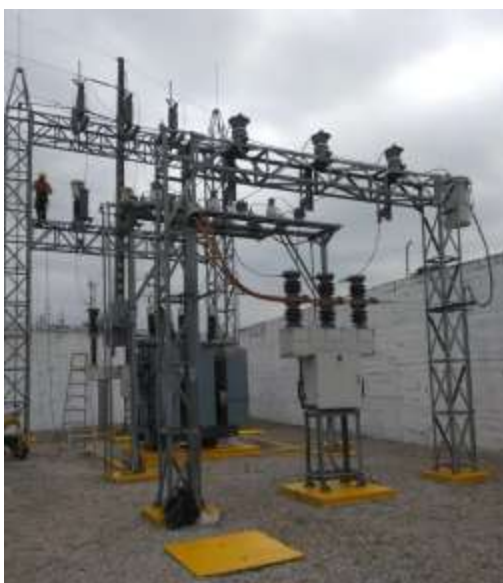
Ilustración 13:Subestación eléctrica Elaborado por Autor
