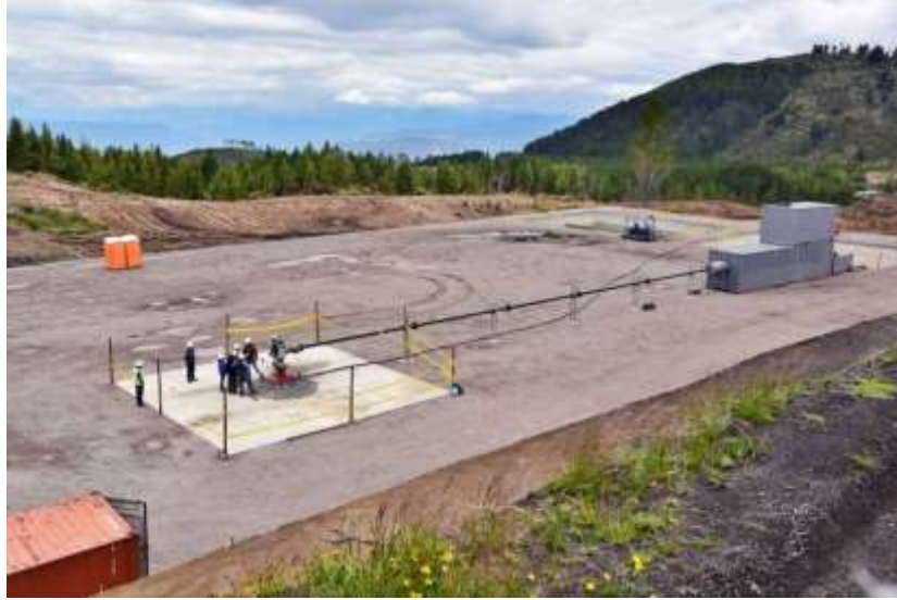
Figura 2.12 Planta Geotérmica Chachimbiro.
