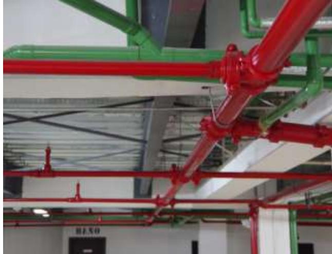
Figura 7 Tuberías de una red de sistema contra incendio
