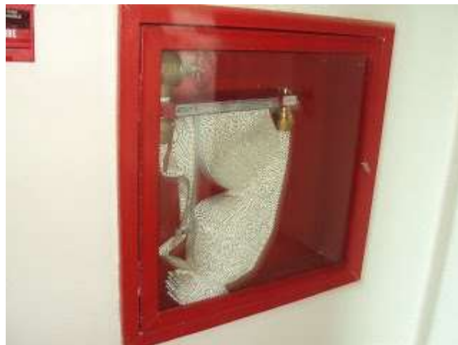
Figura 8 Cajetín de emergencia de un sistema contra incendio
