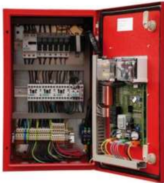
Figura 13 Tablero de control
