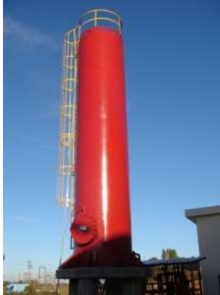
Figura 6 Reservorio de agua del sistema contra incendio
