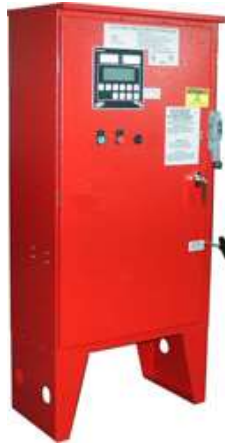
Figura 4 Tablero de control de un sistema contra incendio
