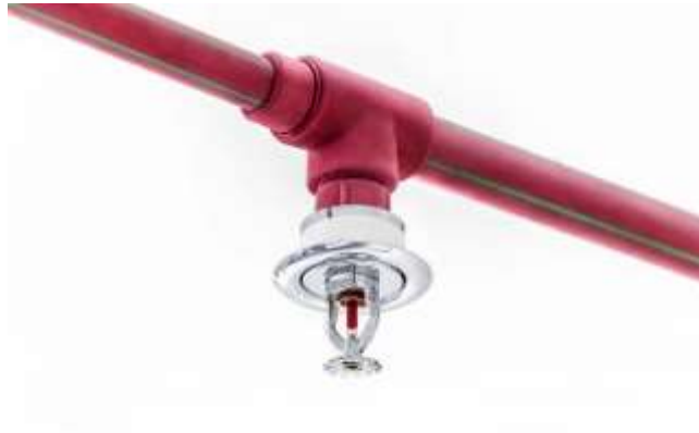
Figura 10 Rociador de un sistema contra incendio
