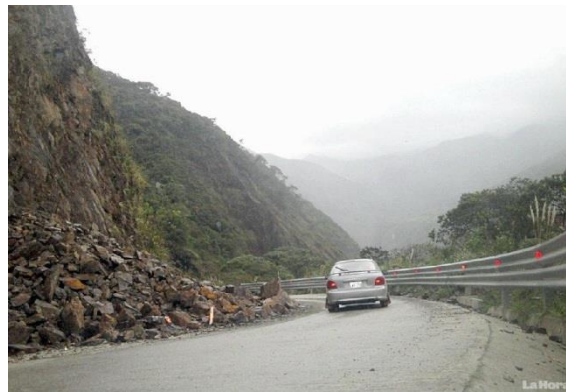
Figura 3.4 Vía de la Región Amazónica en zona de derrumbes
