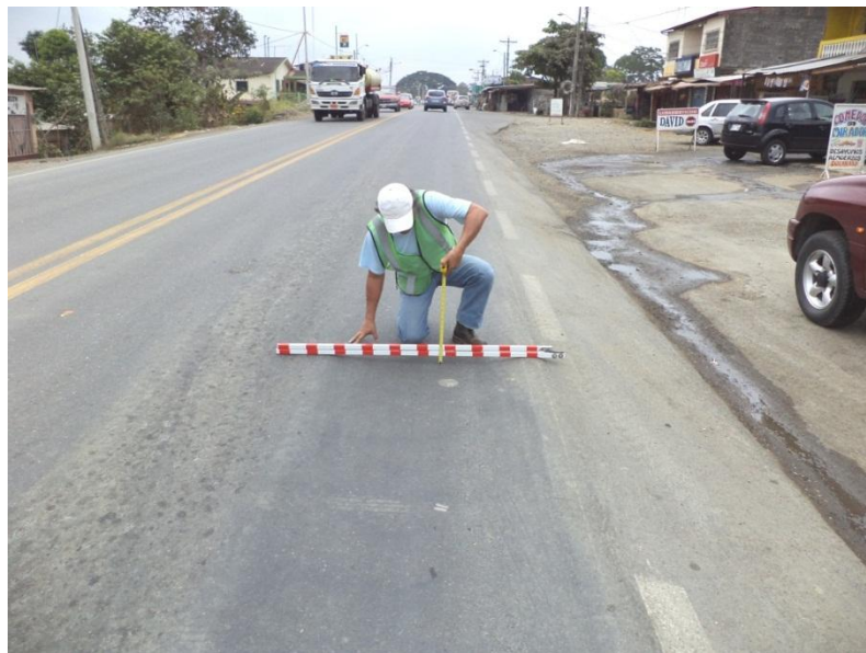
Figura 13. Inspección de cuánto se ha deformado la carpeta asfáltica
