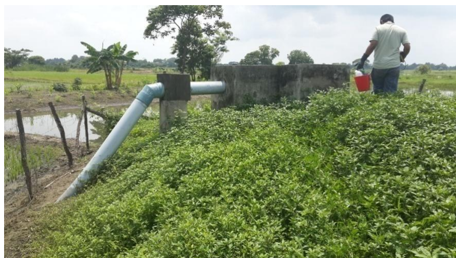
Foto No.3: Precámara- Afluente (Vista Lateral)
