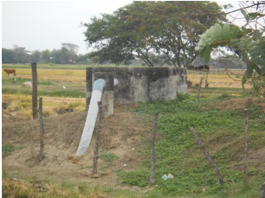
Foto No.4: Precámara- Afluyente (Vista Frontal)
