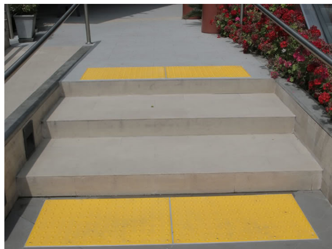
Ilustración 3 La Baldosa o loseta podotáctil escaleras
