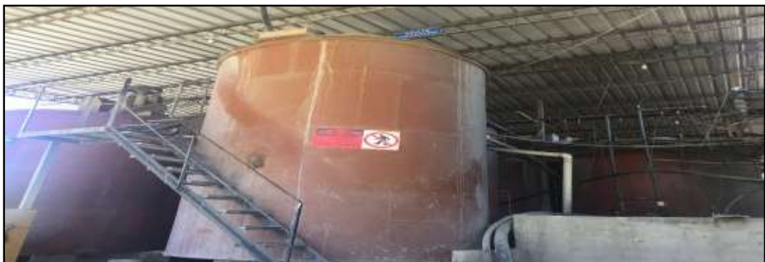
Figura 46. Tanques para el proceso de absorción. Adaptado de “El reporte anual de producción”, por Comivariv S.A (2019).
