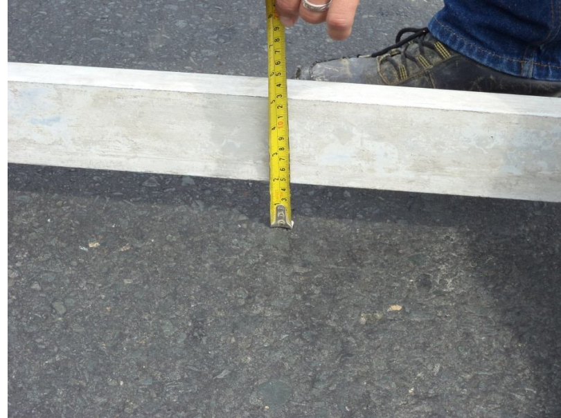
AHUELLAMIENTO (SEVERIDAD ALTA)
