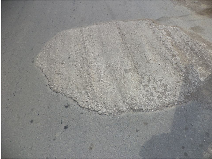
BACHES REPARADOS (SEVERIDAD MEDIA)
