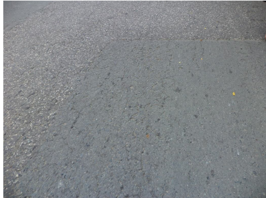
GRIETA PIEL DE COCODRILO (SEVERIDAD MEDIA)
