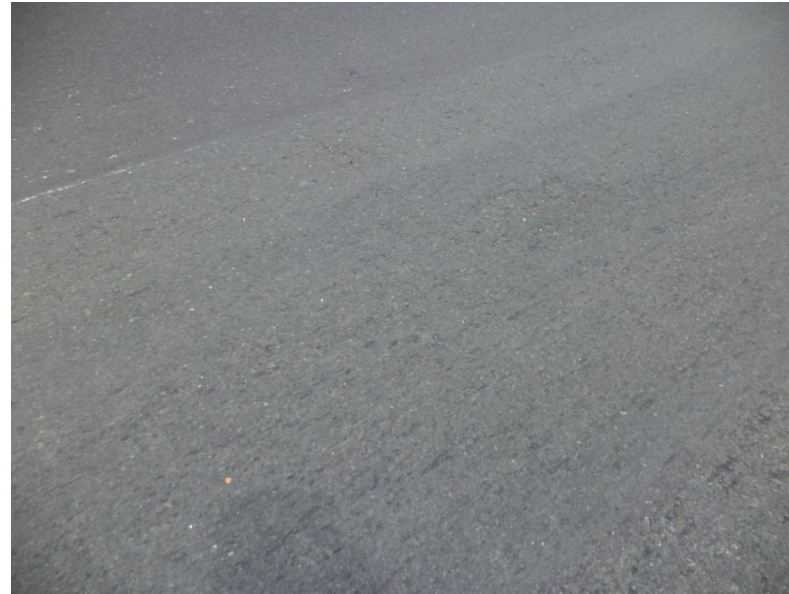
GRIETA PIEL DE COCODRILO (SEVERIDAD BAJA)
