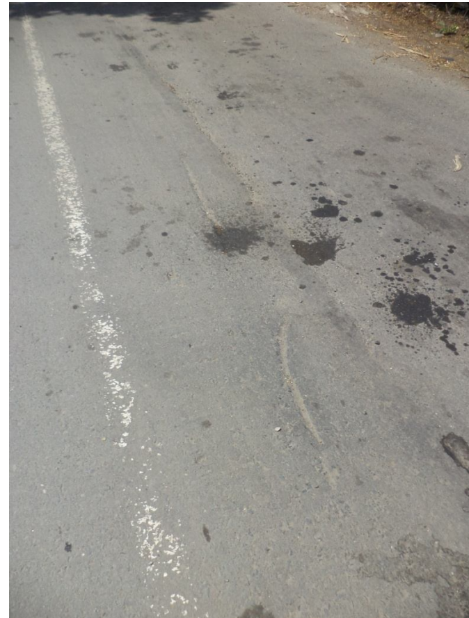
GRIETAS DE BORDE (SEVERIDAD MEDIA)
