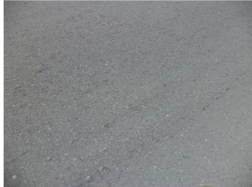
DISGREGACION Y DESINTEGRACION (SEVERIDAD MEDIA)
