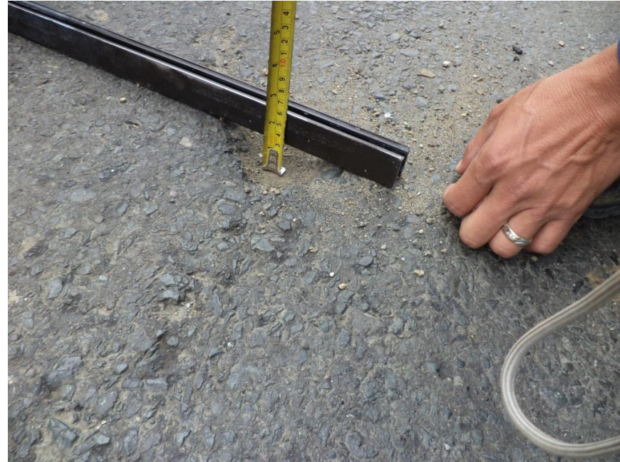
HUECOS (SEVERIDAD MEDIA)
