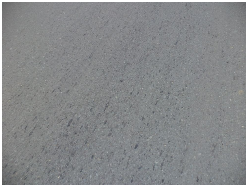
DISGREGACION Y DESINTEGRACION (SEVERIDAD BAJA)
