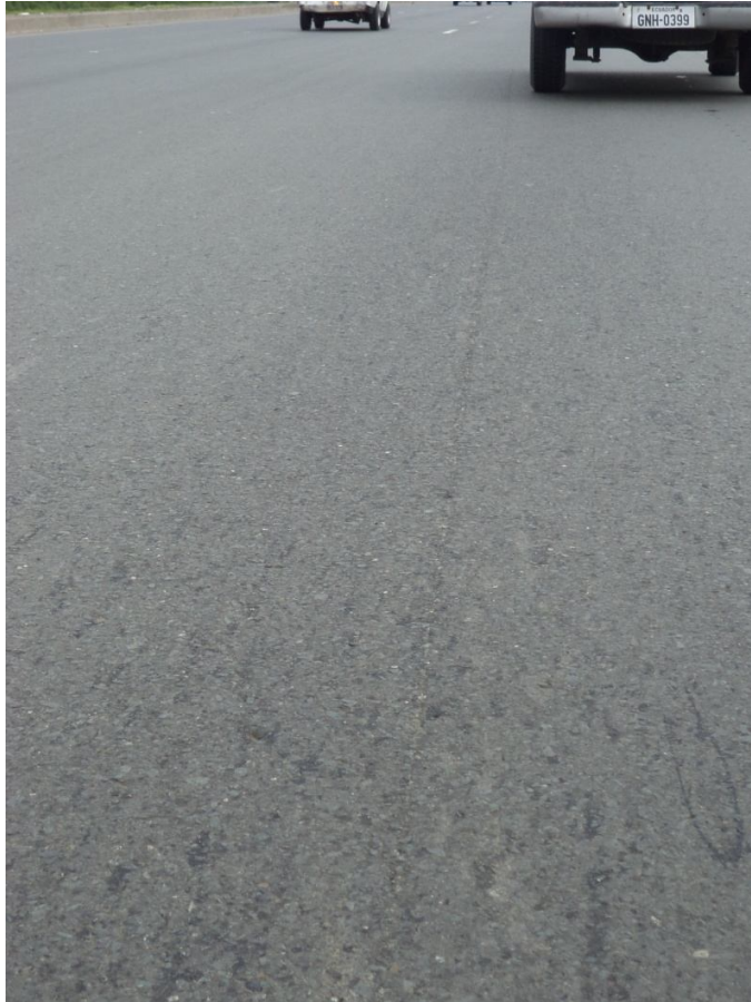
GRIETA LONGITUDINAL (SEVERIDAD MEDIA)
