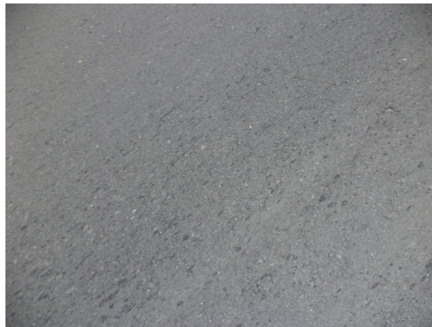
DISGREGACION Y DESINTEGRACION (SEVERIDAD BAJA)
