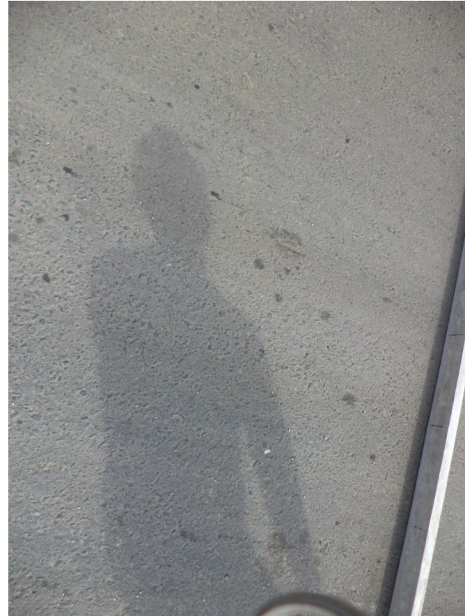
DISGREGACION Y DESINTEGRACION (SEVERIDAD MEDIA)
