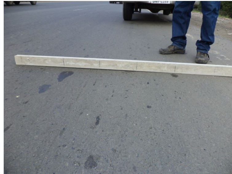
AHUELLAMIENTO (SEVERIDAD BAJA)
