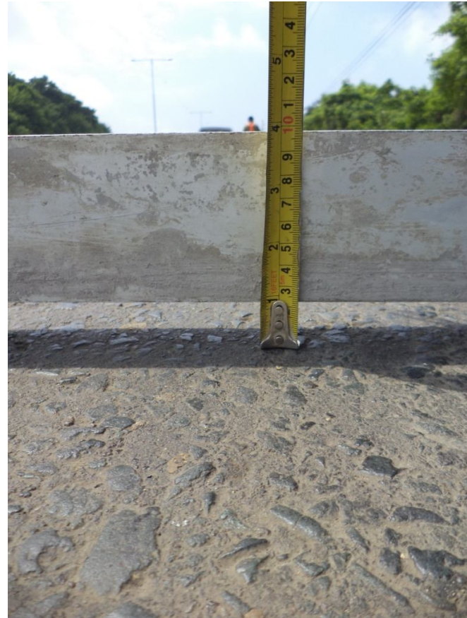
AHUELLAMIENTO (SEVERIDAD ALTA)
