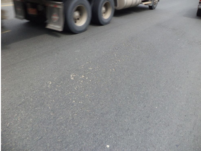
GRIETA PIEL DE COCODRILO (SEVERIDAD MEDIA)
