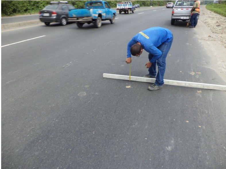
AHUELLAMIENTO (SEVERIDAD BAJA)
