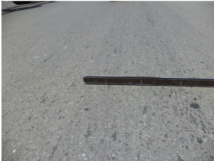
AHUELLAMIENTO (SEVERIDAD BAJA)
