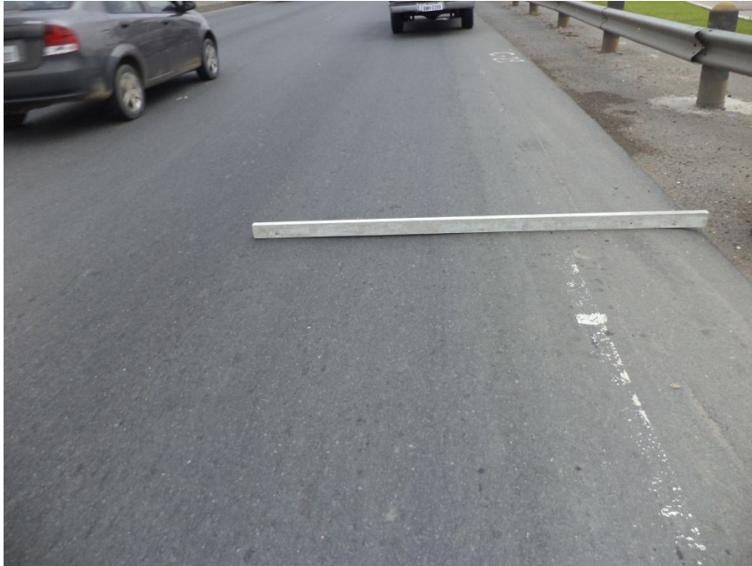
AHUELLAMIENTO (SEVERIDAD MEDIA)
