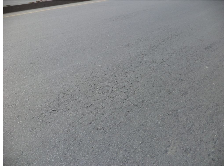
GRIETAS PIEL DE COCODRILO (SEVERIDAD MEDIA)
