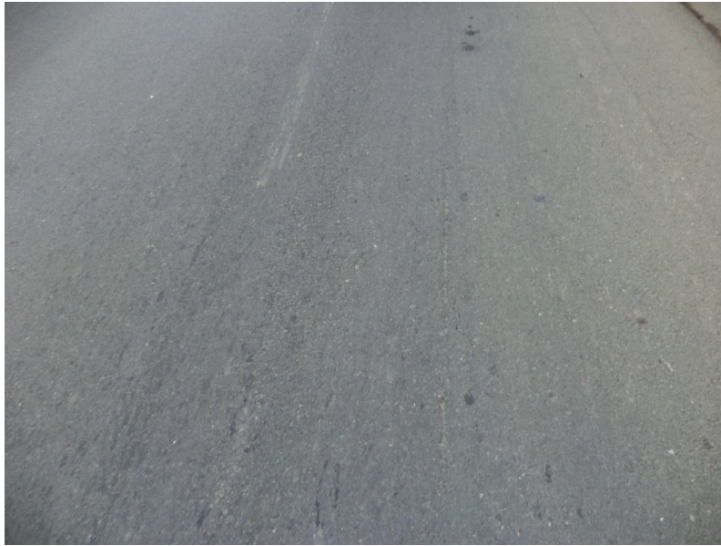
GRIETA LONGITUDINAL (SEVERIDAD BAJA)
