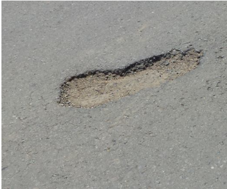
BACHE (SEVERIDAD ALTA)
