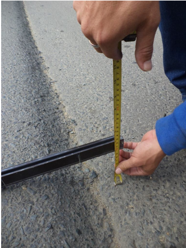
DESNIVEL CALZADA-HOMBRO (SEVERIDAD ALTA)
