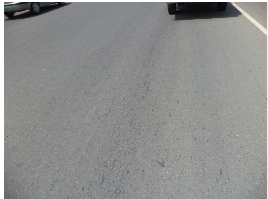
DISGREGACION Y DESINTEGRACION (SEVERIDAD BAJA)
