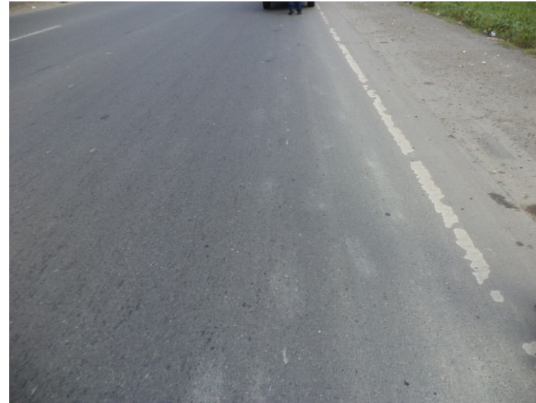
DISGREGACIÓN Y DESINTEGRACIÓN (SEVERIDAD BAJA)
