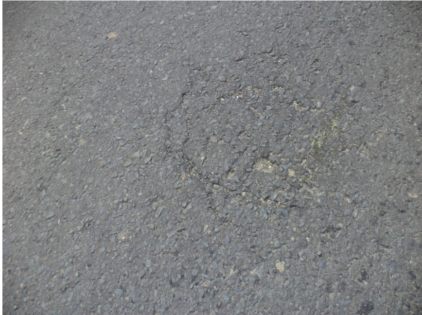
GRIETAS PIEL DE COCODRILO (SEVERIDAD MEDIA)
