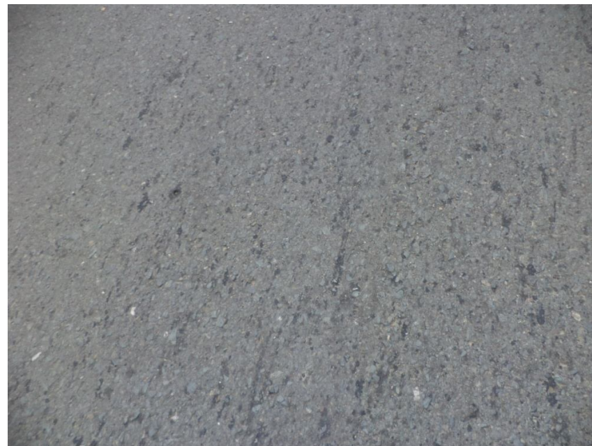
DISGREGACION Y DESINTEGRACION (SEVERIDAD MEDIA)
