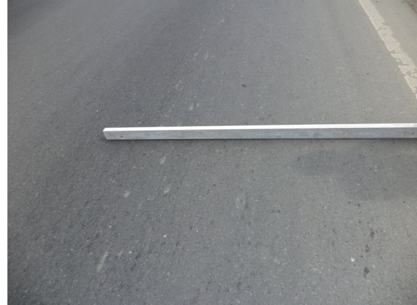
AHUELLAMIENTO (SEVERIDAD BAJA)
