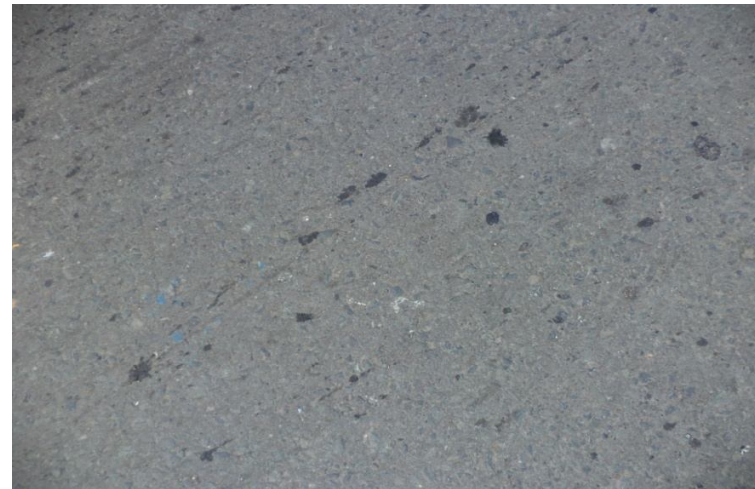
DISGREGACIÓN Y DESINTEGRACIÓN (SEVERIDAD MEDIA)
