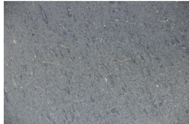
DISGREGACIÓN Y DESINTEGRACIÓN (SEVERIDAD MEDIA)
