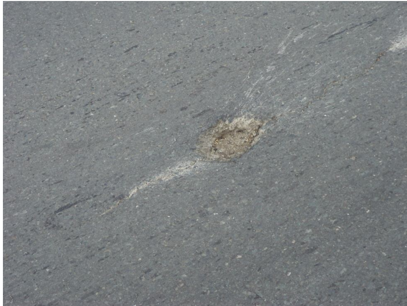
BACHES (SEVERIDAD MEDIA)
