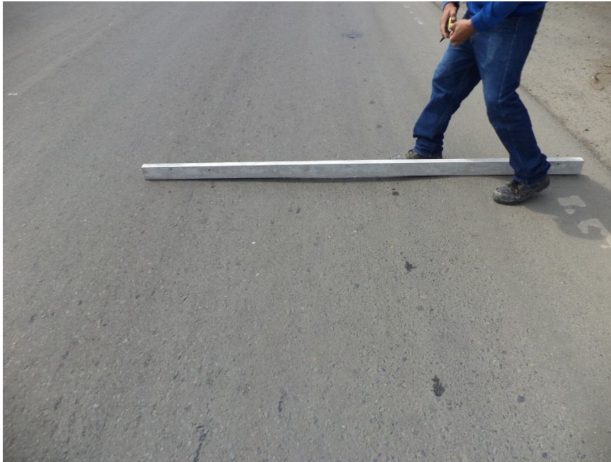
AHUELLAMIENTO (SEVERIDAD BAJA)
