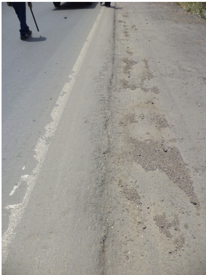
GRIETAS DE BORDE (SEVERIDAD MEDIA)
