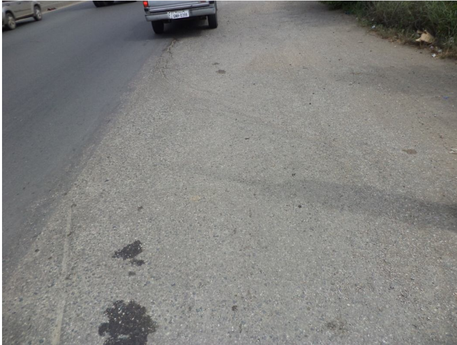
BACHE REPARADO (SEVERIDAD BAJA)
