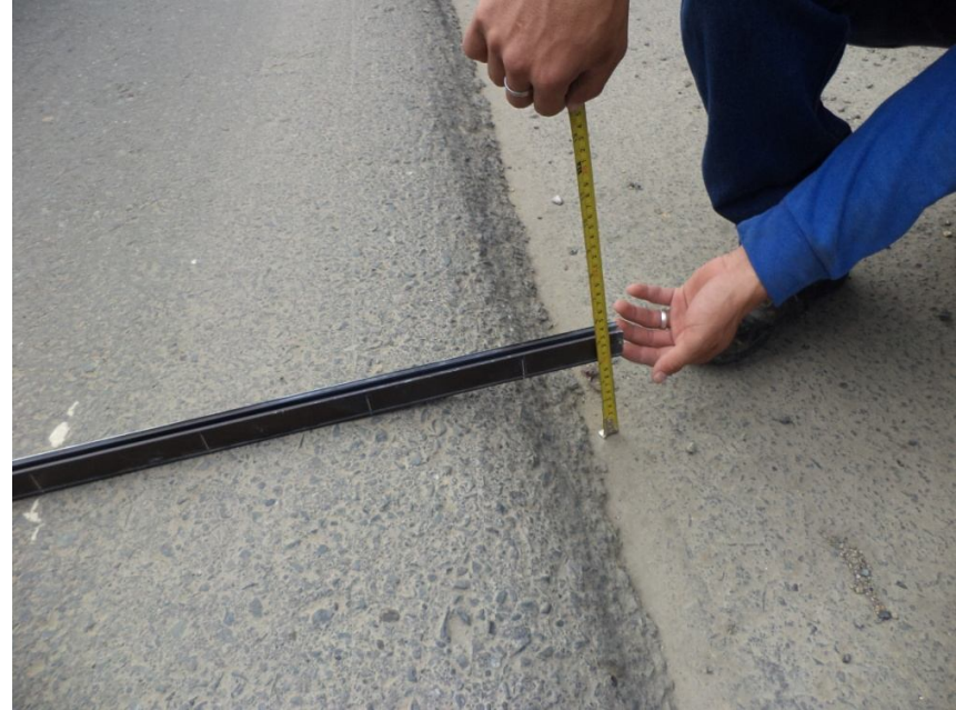
DESNIVEL CALZADA-HOMBRO (SEVERIDAD MEDIA)
