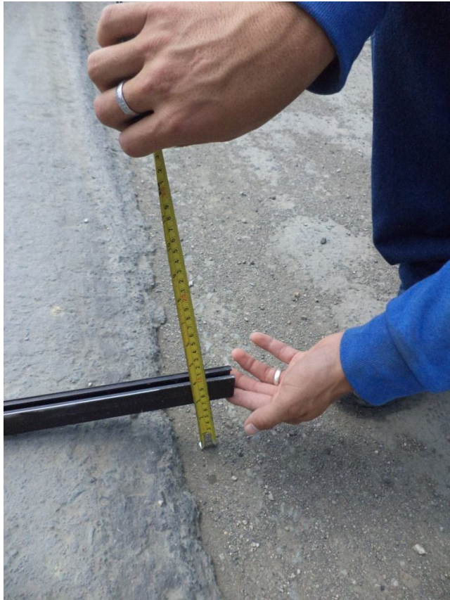
DESNIVEL CALZADA - HOMBRO (SEVERIDAD MEDIA)
