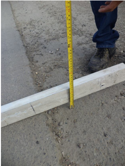
DESNIVEL CALZADA-HOMBRO (SEVERIDAD BAJA)
