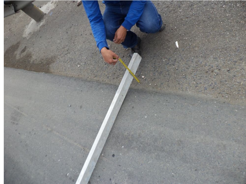
DESNIVEL CALZADA-HOMBRO (SEVERIDAD MEDIA)
