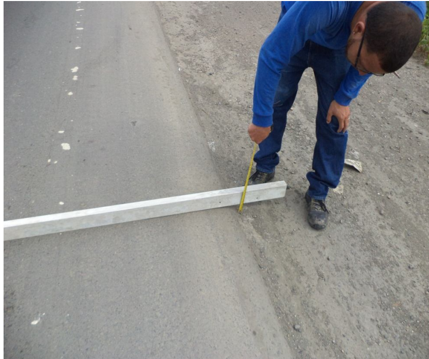
DESNIVEL CALZADA-HOMBRO (SEVERIDAD BAJA)
