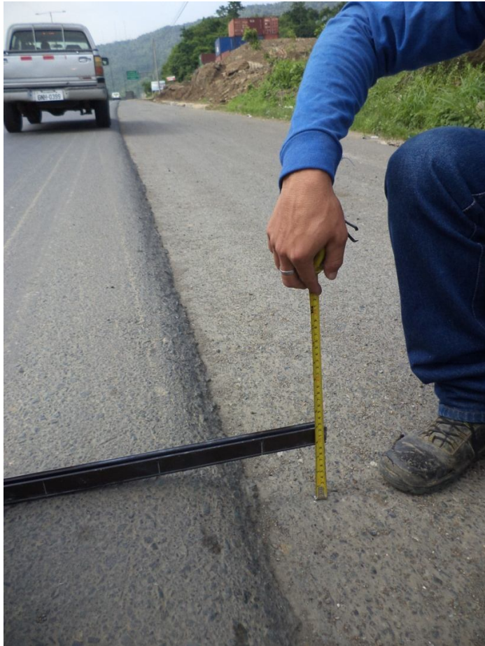
DESNIVEL CALZADA-HOMBRO (SEVERIDAD MEDIA)
