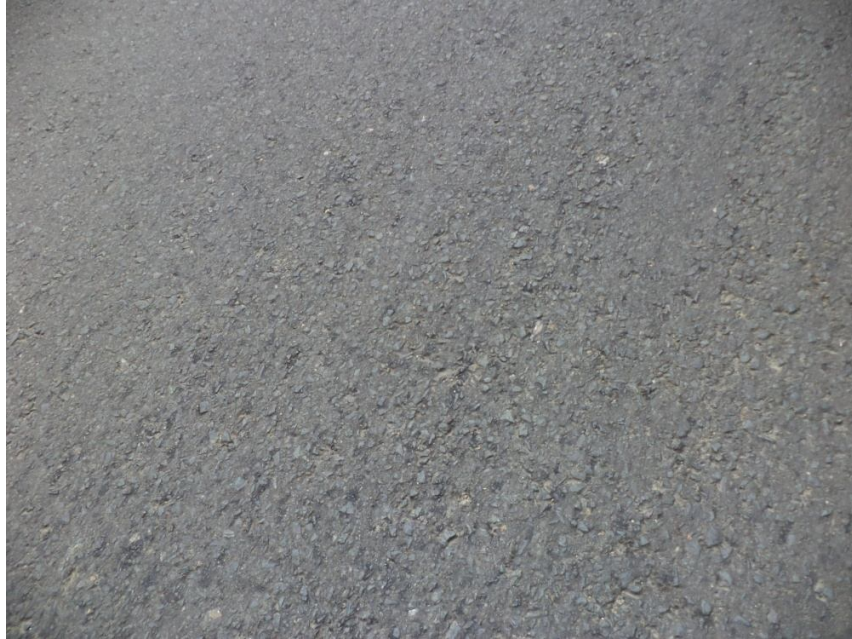
GRIETAS PIEL DE COCODRILO (SEVERIDAD BAJA)
