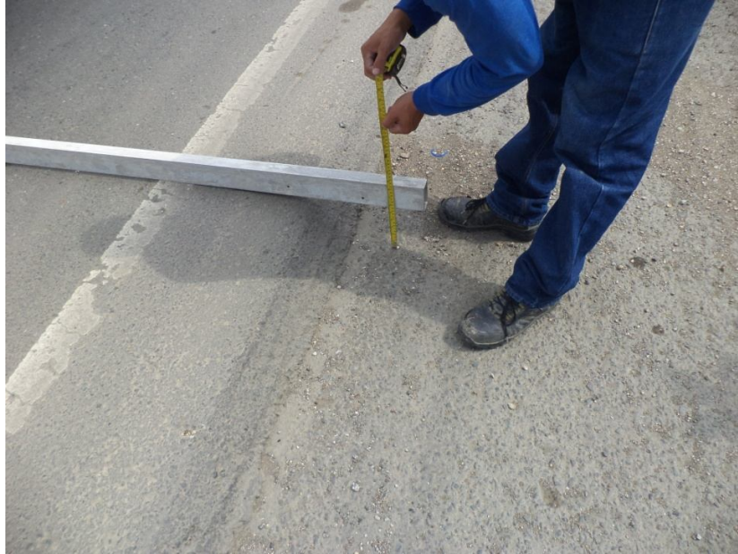
DESNIVEL CALZADA - HOMBRO (SEVERIDAD ALTA)
