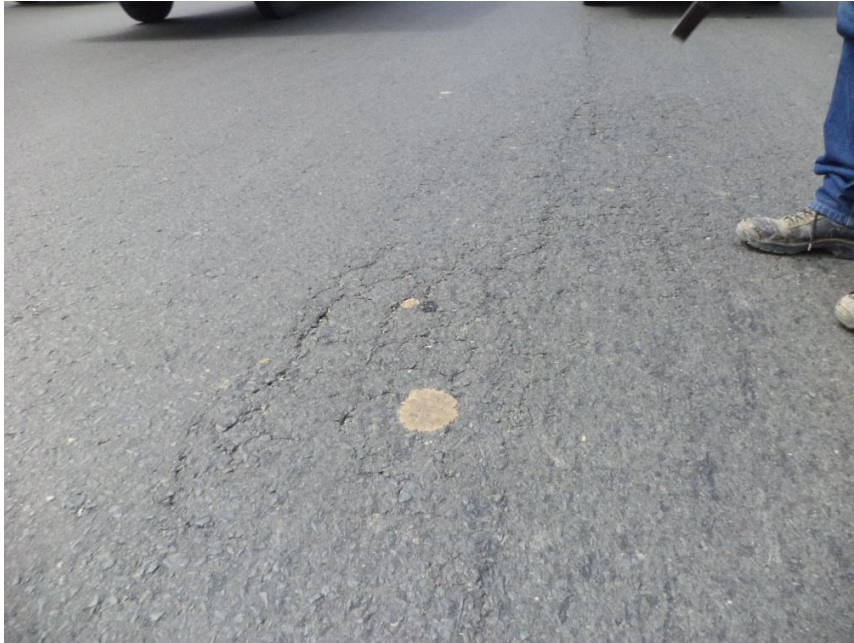
GRIETAS PIEL DE COCODRILO (SEVERIDAD ALTA)
