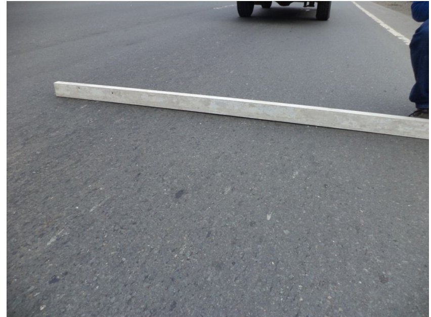
AHUELLAMIENTO (SEVERIDAD BAJA)
