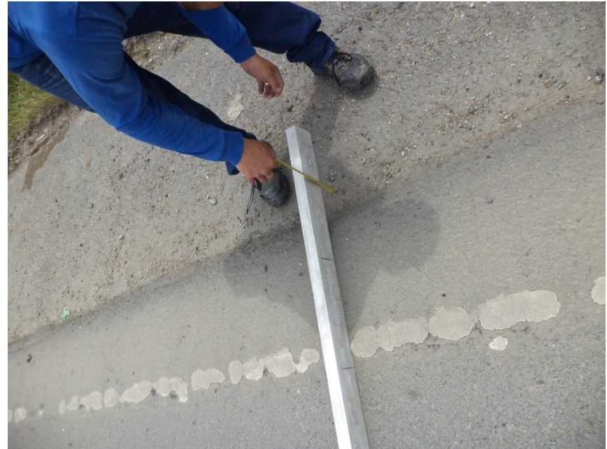
DESNIVEL CALZADA-HOMBRO (SEVERIDAD ALTA)
