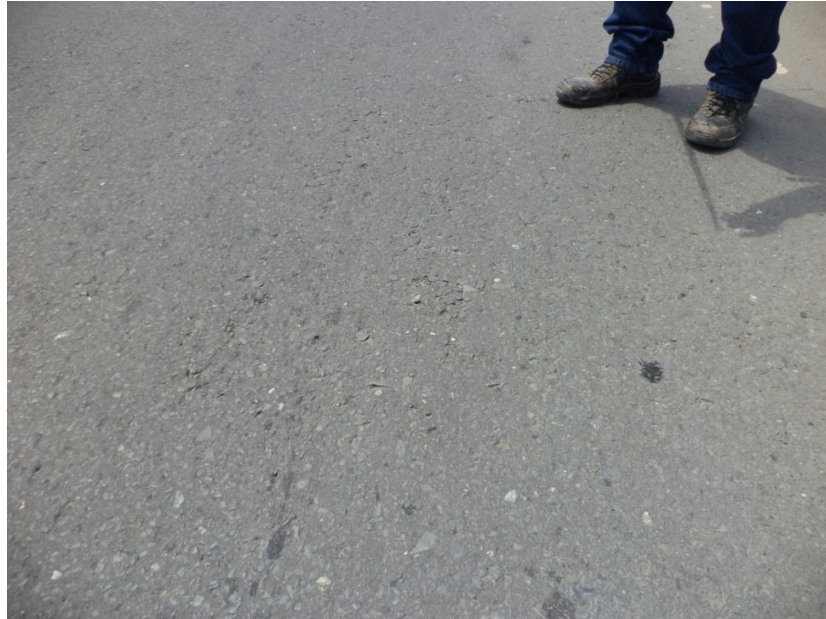
GRIETAS PIEL DE COCODRILO (SEVERIDAD BAJA)
