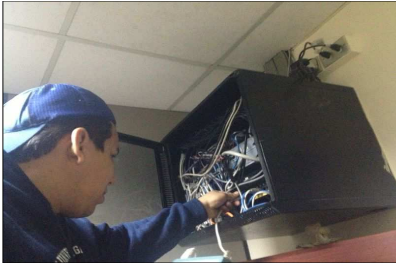
Figura 3.5 Revisión de cables de red en rack principal
