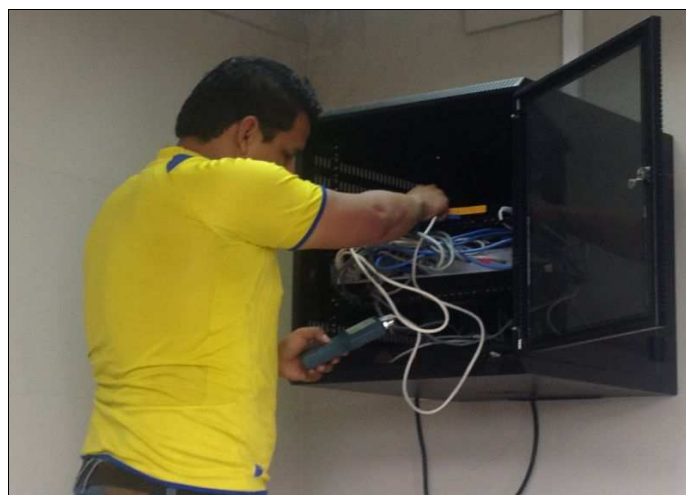
Figura 3.10 Revisión de Rack del ICAIM
