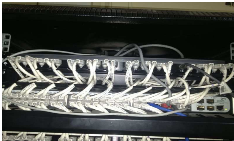
Figura 3.6 Ordenamiento correcto en rack principal de FAH
