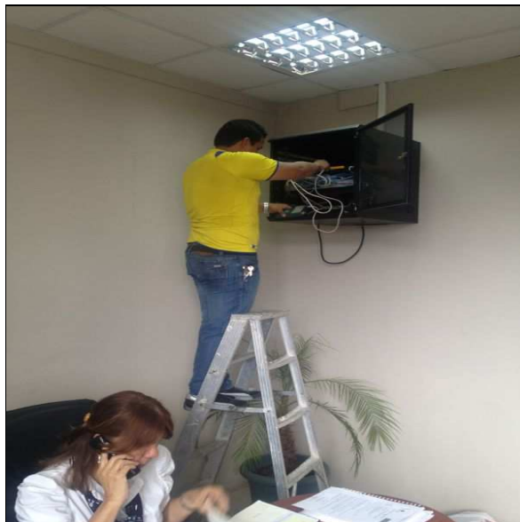
Figura 3.11 Reordenamiento de cables de red en el rack ICAIM
