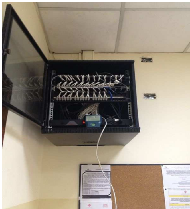
Figura 3.9 Rack sala de lectura aplicando la norma TIA/EIA-606-A
