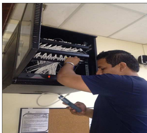
Figura 3.8 Reordenamiento de puertos en rack sala de música de FAH
