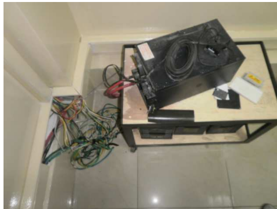
Figura 3.20: Banco de batería mal instalado.
