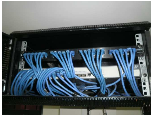
Figura 3.21: Rack laboratorio 3 Fuente: Fotografiada por Autor
