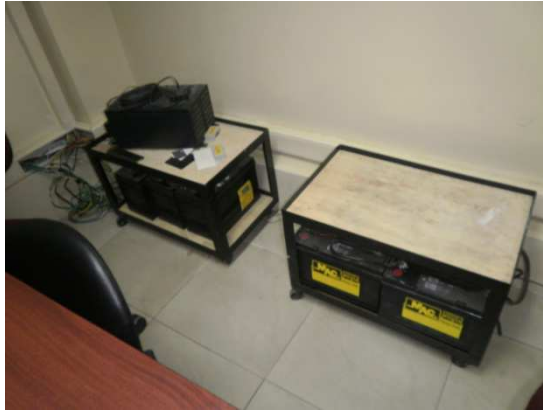
Figura 3.19: Bancos de baterías
