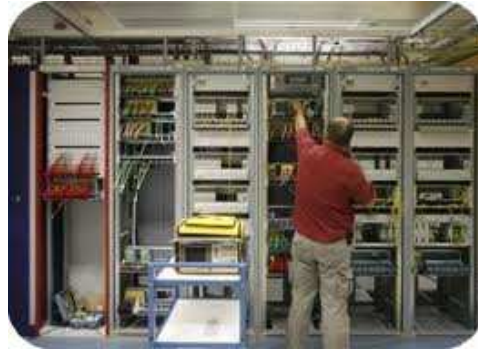
Figura 2.38: Cuarto de Equipos Fuente: katatago1997.blogspot.com
