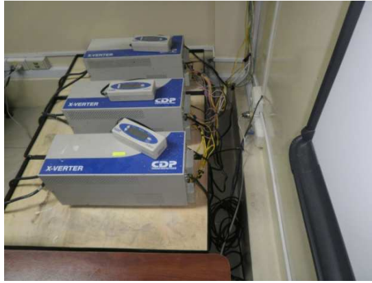
Figura 3.16: Instalaciones eléctricas de bancos de baterías en mal estado.
