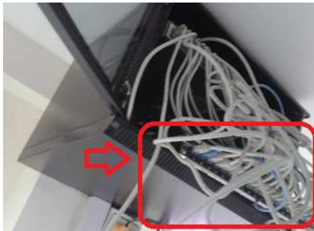
Figura 3.18: Patch panel no está anclado al rack.
