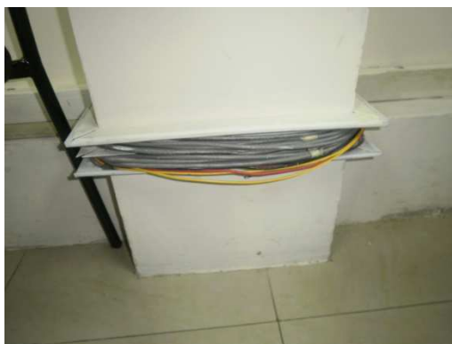
Figura 3.14: Cableado laboratorio 1 en mal estado
