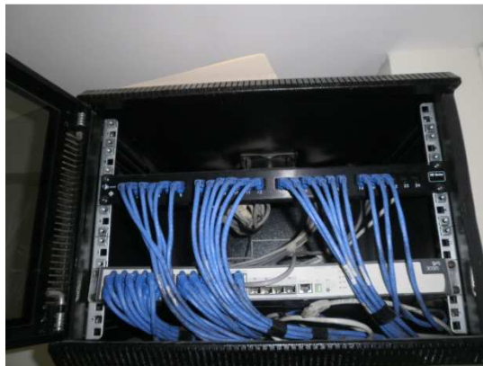
Figura 3.13: Rack laboratorio 1 Fuente: Fotografiada por Autor
