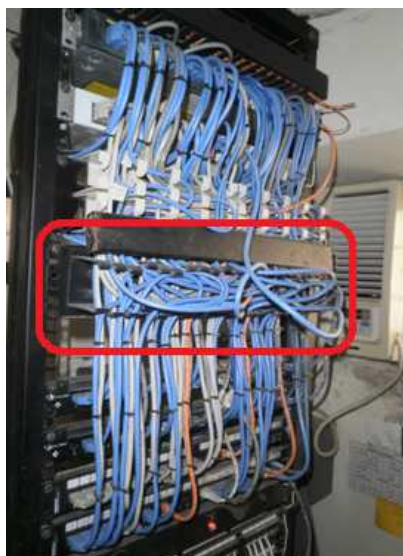
Figura 3.10: Rack principal de la red de laboratorios de FAH
