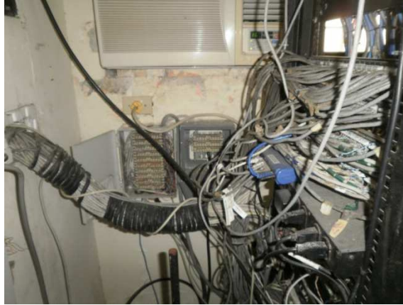
Figura 3.11: Mal estado de todo el cableado estructural del rack principal.
