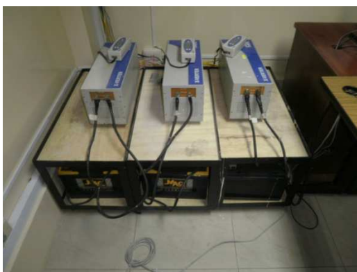
Figura 3.15: Bancos de baterías
