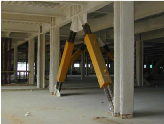
Figura 38 Arriostramientos de Pandeo Restringido Instalados en el Centro Médico Santa Clara, Santa Clara, California (Symans, 2008)
