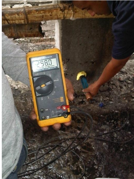
Figura 16 Medición de potencial de corrosión
