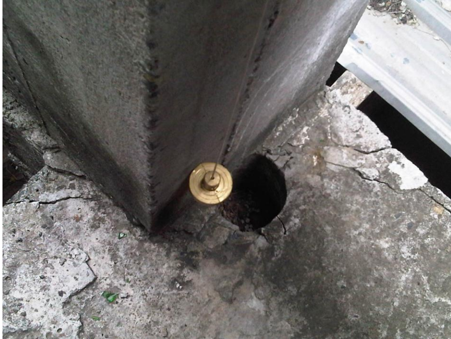
Figura 13 Fisuras en ciertos macizos esquineros
