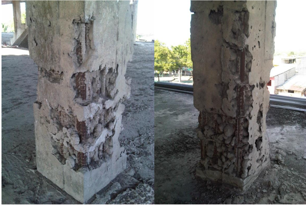
Figura 8 Oquedades que se presentan en ciertas columnas
