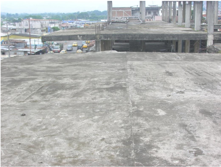
Figura 12 Se puede observar una ligera deflexión en la losa de volado
