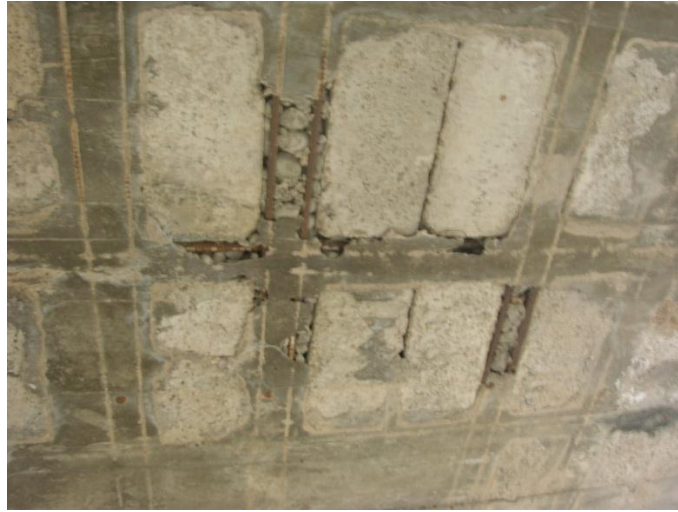
Figura 6 Varillas expuestas en los nervios de las losas
