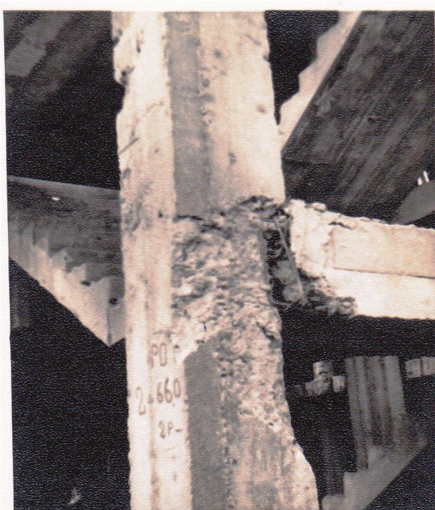
Figura 17 Falla a la que hacemos referencia.
