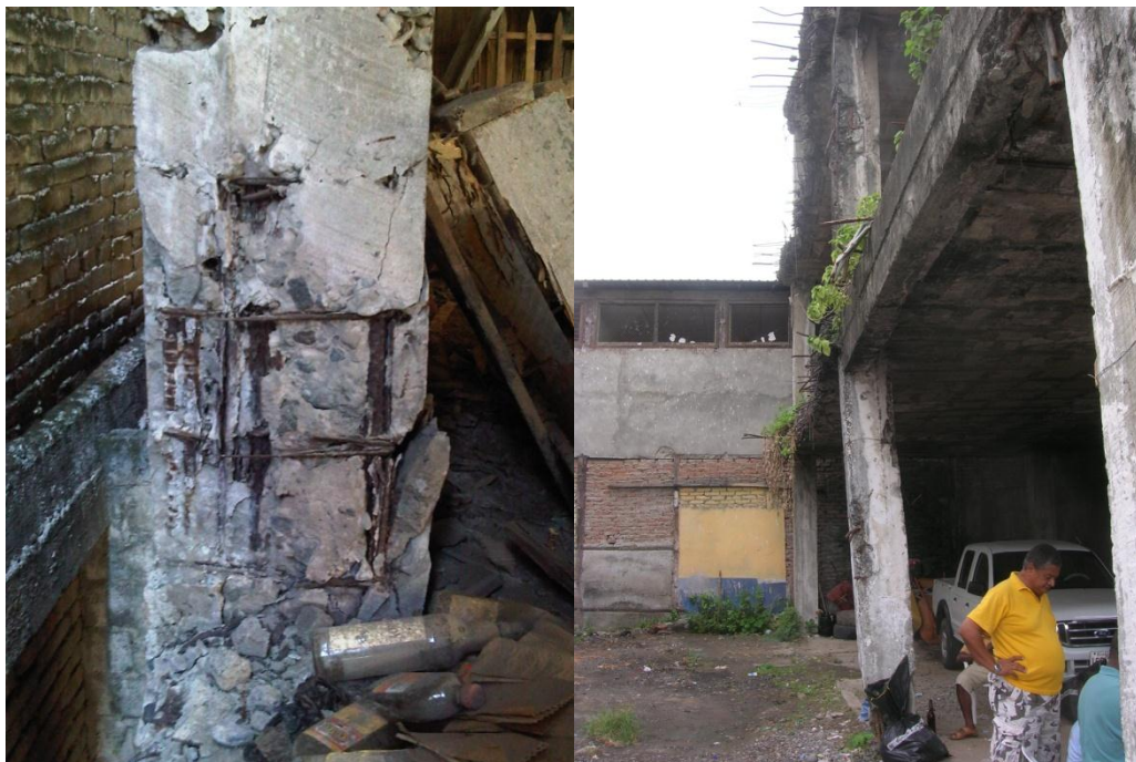
Figura 10 Columnas en donde se puede apreciar daños considerables
