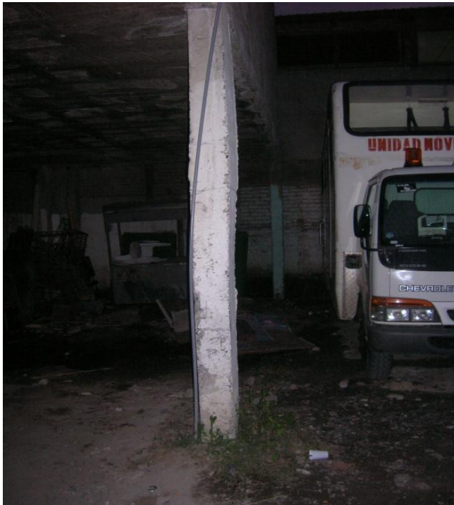
Figura 11 Columna donde se observa un ligero pandeo
