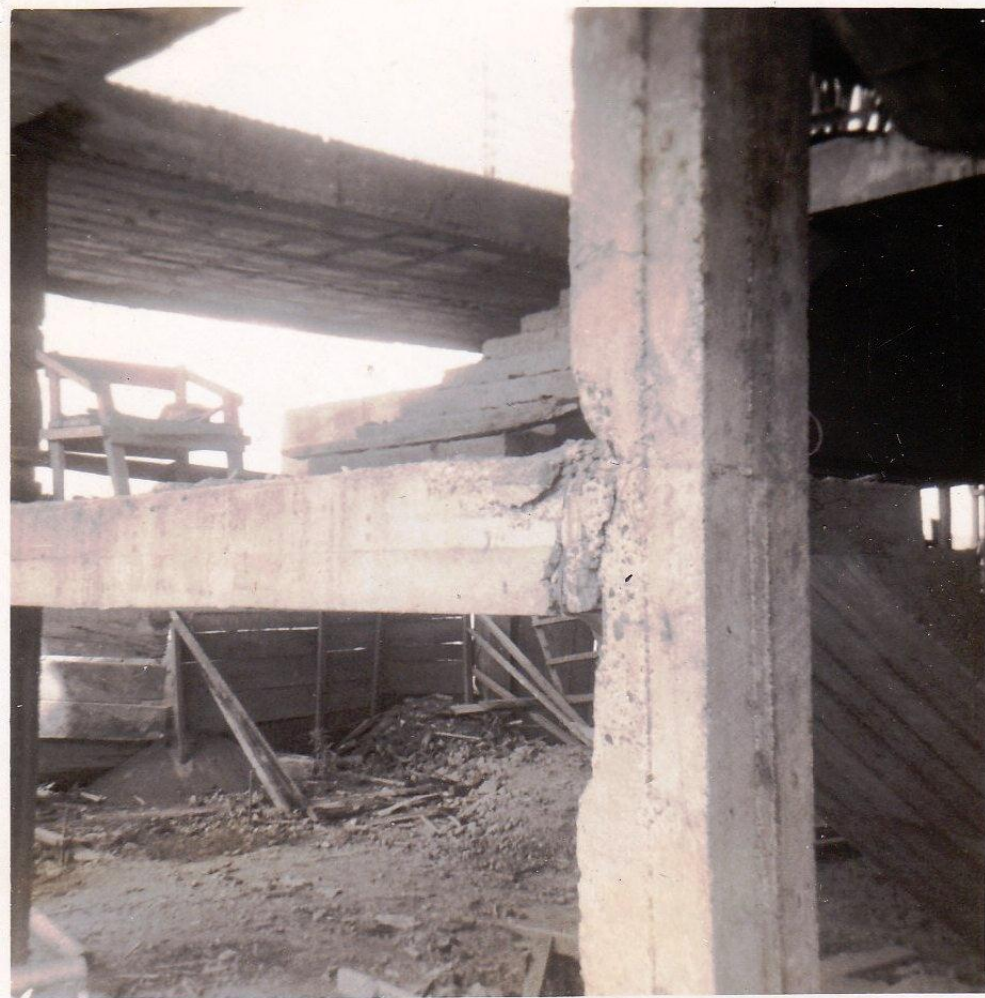
Figura 18 Falla a la que hacemos referencia
