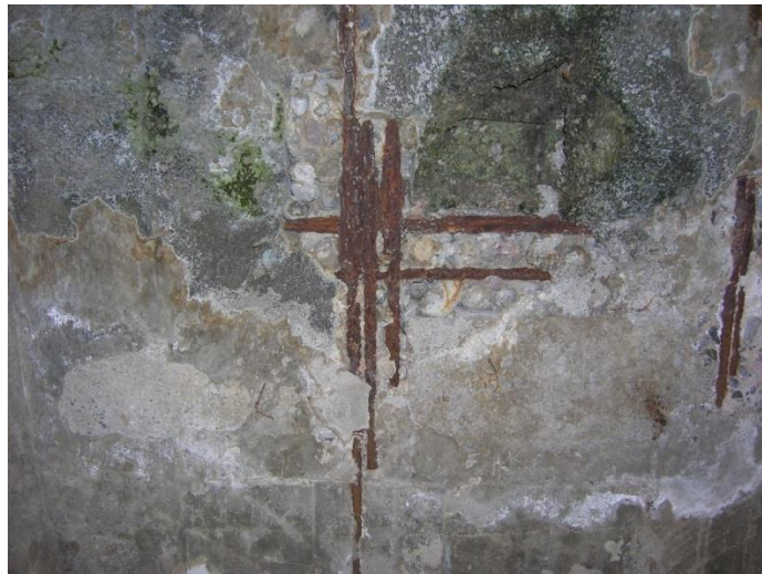
Figura 7 Daño a las varillas debido a la oxidación
