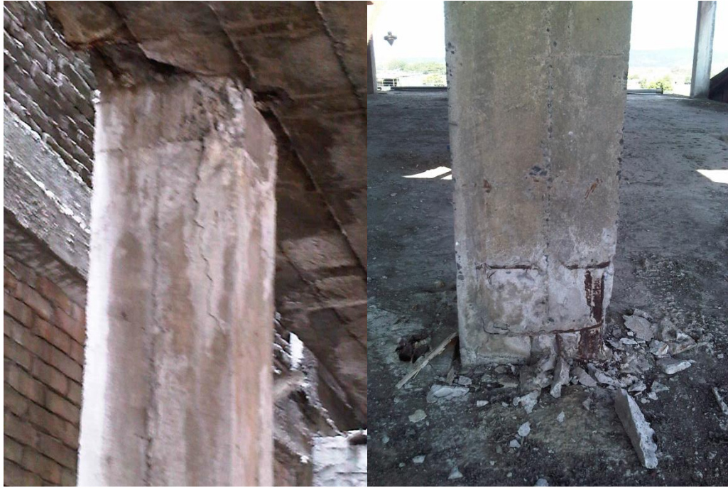
Figura 9 Lugares donde se puede identificar el Hormigón reventado
