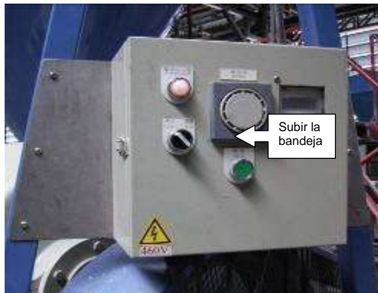
Figura 45. Switch para bandeja de tolva.
