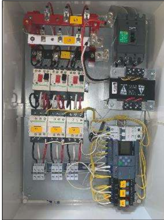
Figura 4. 16 Cableado de elementos en tablero de control
