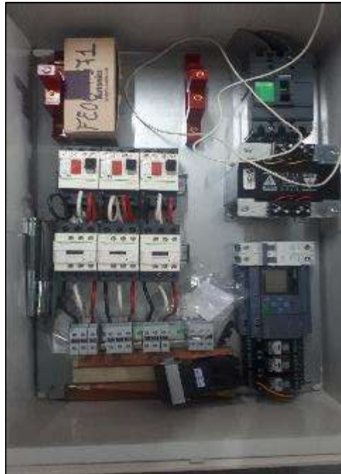
Figura 4. 14 Posicionamiento de elementos en tablero de control
