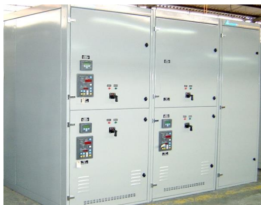
Figura 3. 27 Tablero de media tensión. Fuente: (CELCO, 2019)
