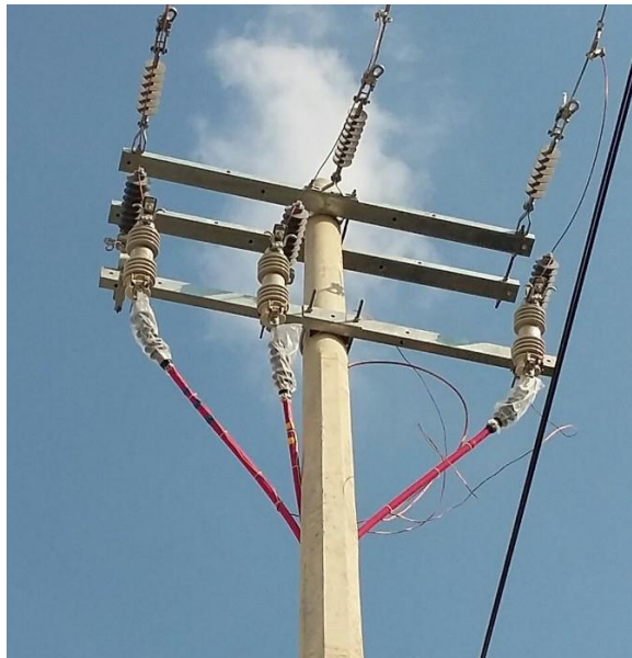
Figura 3. 25 Acometida de media tensión. Fuente: El autor
