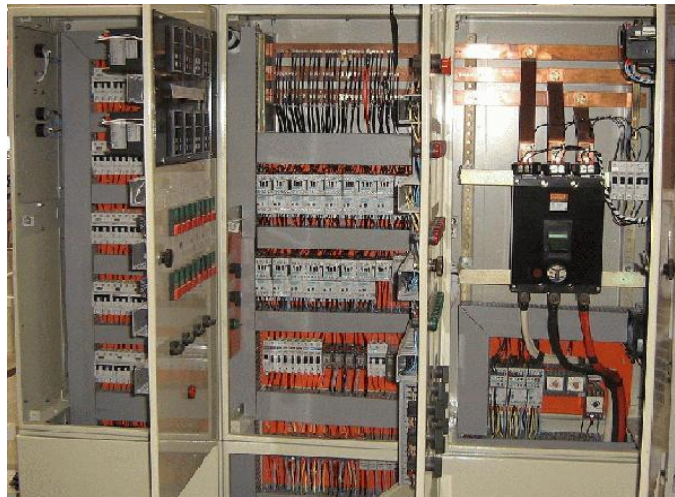
Figura 3. 32 Tablero de control baja tensión. Fuente: El autor
