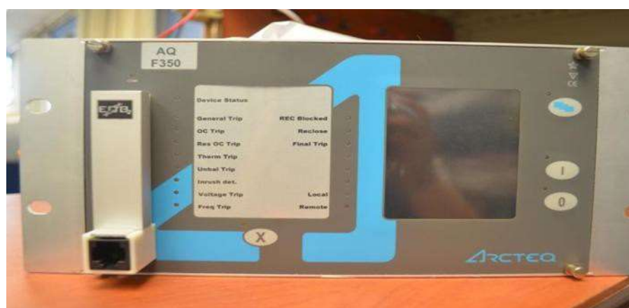
Figura 2. 3 Relé AQ F350 instalados en la casa comando de la subestación Gonzanamá.
