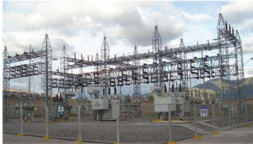
Figura 2. 2 Subestación Alpachaca patio de 69 kV
