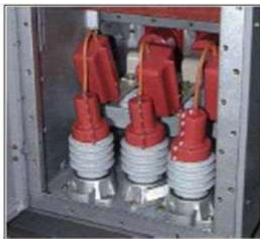
Figura 2. 26 Apartarrayos en equipo metal-clad
