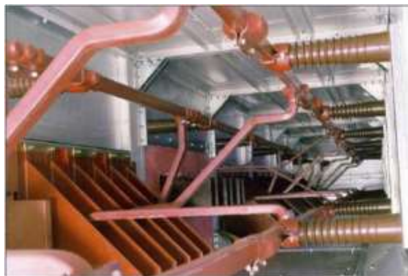
Figura 2. 17 Embarrado de equipo metal-clad.
