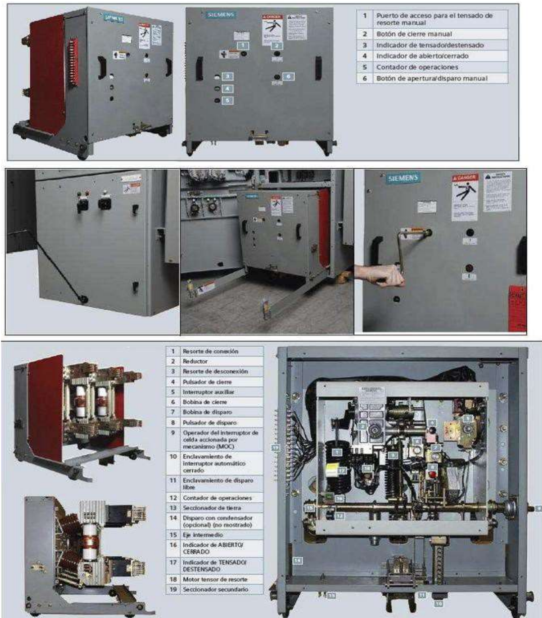
Figura 2. 14 Interruptor automático extraíble en vacío para celdas metal-clad.
