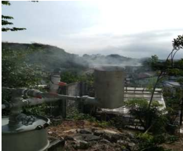
Figura 35. Salida de gas en area de quemador
