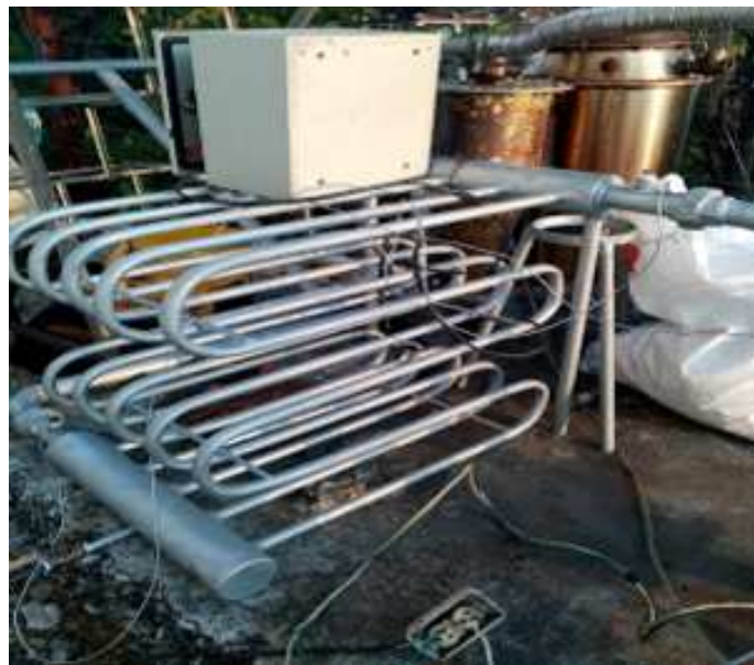
Figura 39. Intercambiador de calor
