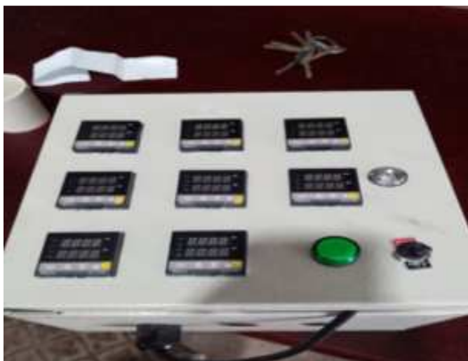
Figura 37. Panel de control de temperatura
