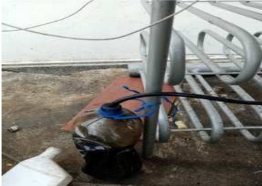
Figura 40. Retencion y depósito de condensacion con alquitranes
