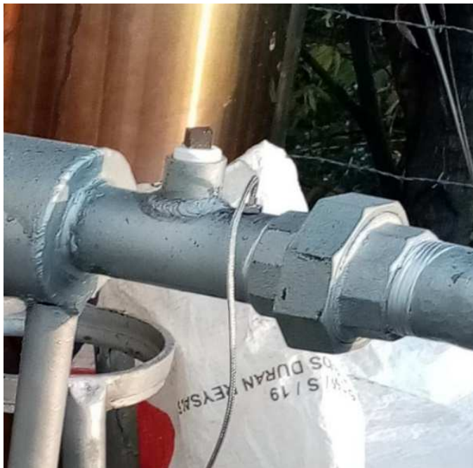
Figura 36. Termocupla en salida de intercambiador
