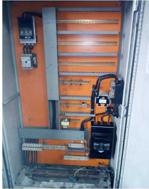
Figura 4.53: Tablero eléctrico de control. Obtenido: Ecuacable S.A.
