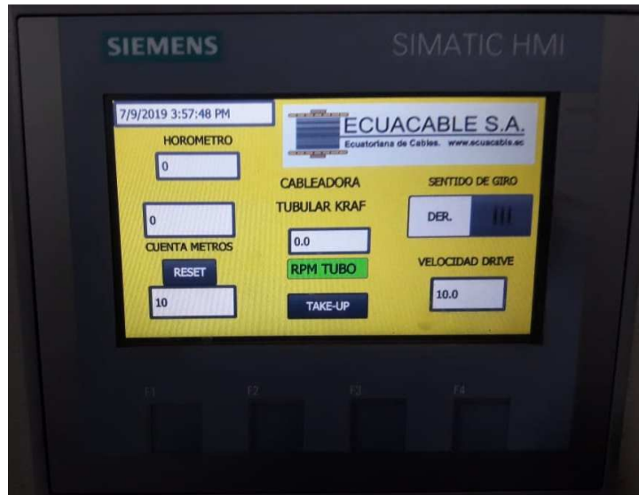
Figura 4.56: Pantalla HMI KTP 400 Siemens. Obtenido: Ecuacable S.A.
