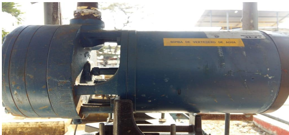
Figura No. 34 Bomba para vertedero
