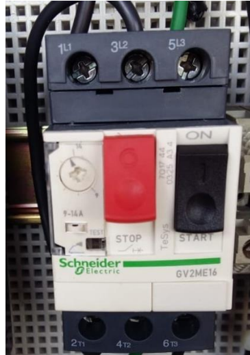
Figura No. 38 Breaker principal del sistema de control
