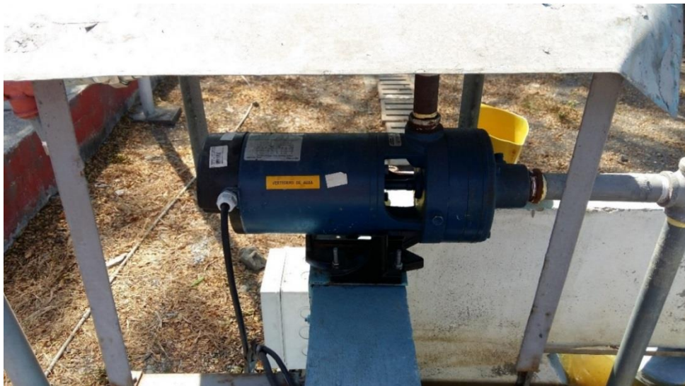
Figura No. 33 Bomba para servicios generales
