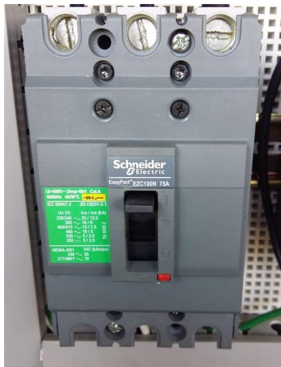
Figura No. 37 Breaker principal del sistema de control
