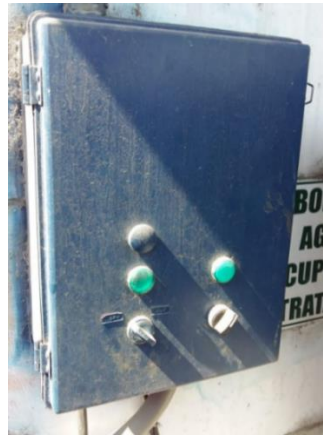
Figura No. 46 Tablero de control de fuerza para el sistema de bombeo
