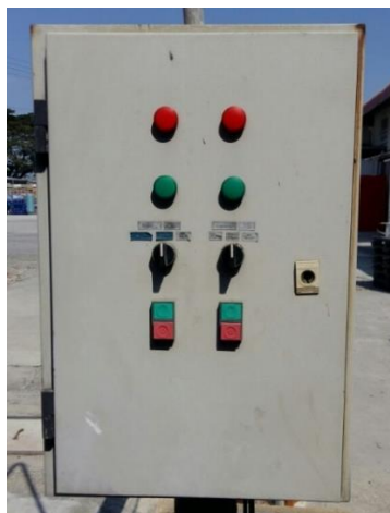
Figura No. 27 Tablero de control de fuerza sistema de bombeo antiguo
