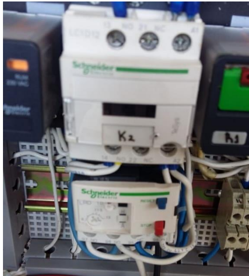
Figura No. 41 Dispositivo de protección para arranque de motor 2HP
