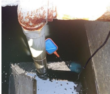
Figura No. 48 Boya de la cisterna de recuperación de aguas residuales
