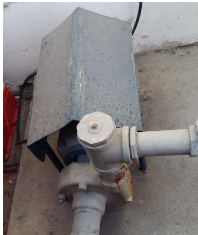
Figura No. 45 Bomba para servicios generales
