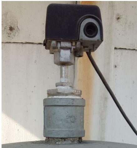
Figura No. 44 Presostato para bomba de 10HP
