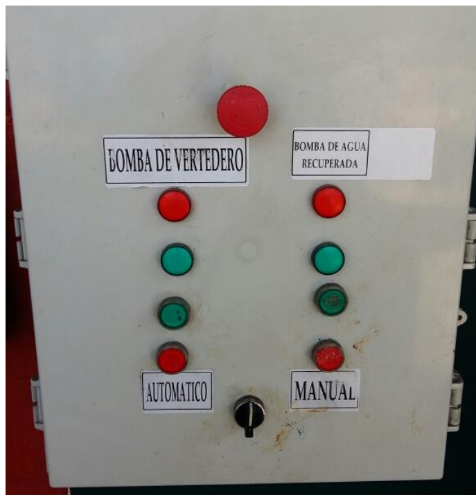
Figura No. 36 Tablero de control para sistema de bombeo automatizado
