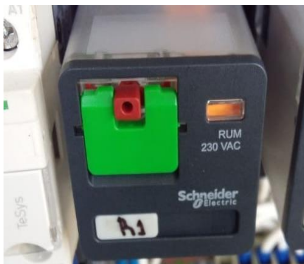
Figura No. 42 Relé de protección para bomba de 10 HP
