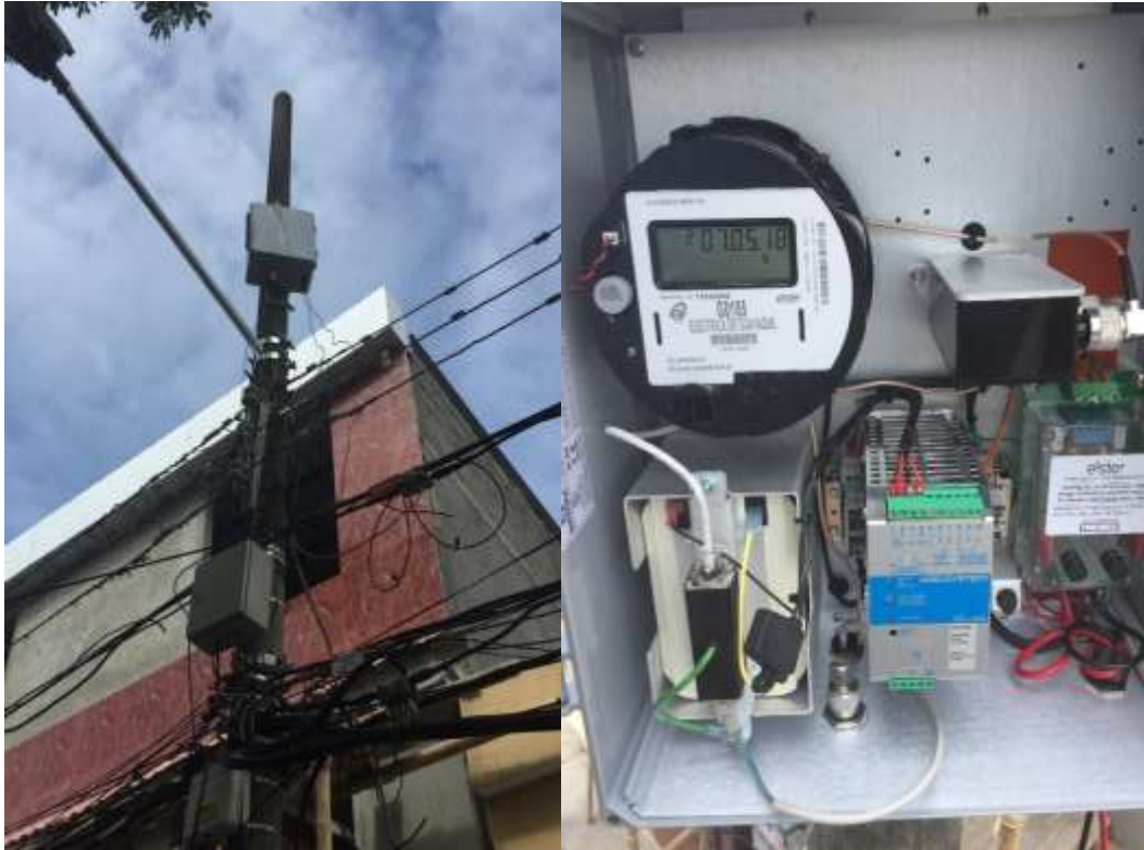
Figura 4.5 Colector con enlace GPON
