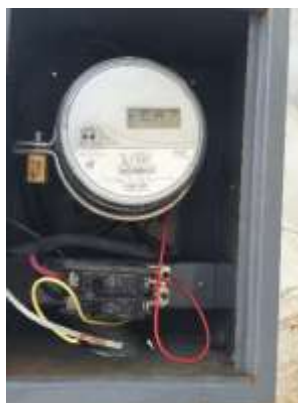
Figura 2.3 Medidor AMI CNEL EP
