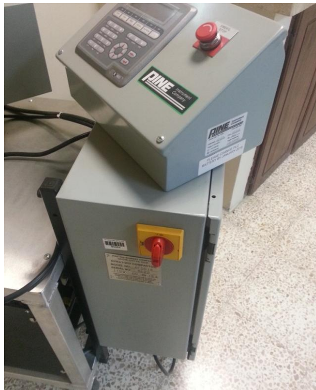
Gráfico 6-3: Interruptor de encendido principal (con placa amarilla) en posición vertical.
