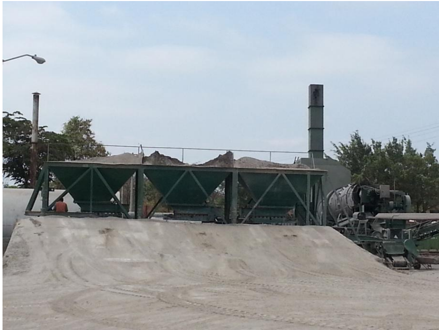
Gráfico 2-2: Tolvas que contienen los agregados en una planta de mezcla asfáltica.
