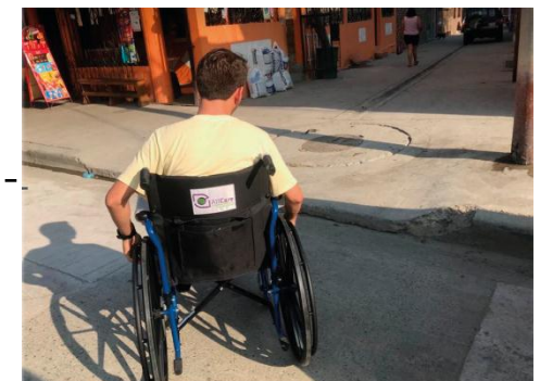
Fig. 45: Rampas en mal estado Autor: Flores, Forestieri, Surbia, Tumalie. (2018)
