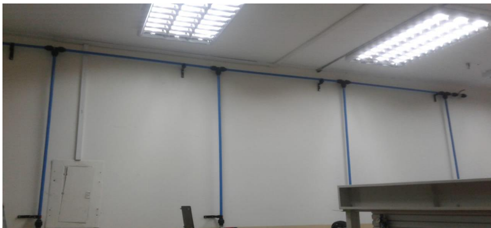
Figura 4. 13 Instalación de aire comprimido en laboratorio de Neumática de la FETD
