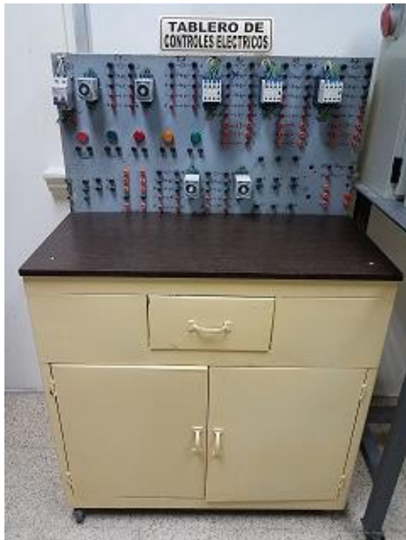
Figura 3. 2: Tablero de controles eléctricos actuales. Fuente: Autor
