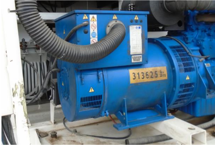
Figura 2.6: Generador eléctrico de 230 KW, 400 V, 50Hz. Tomado de Refinería La Libertad.
