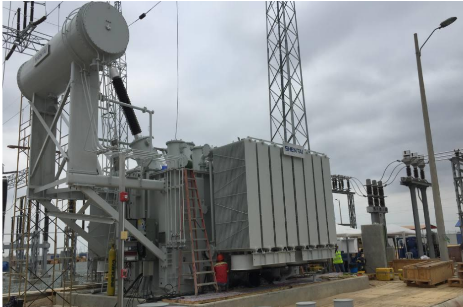
Figura 2.7: Transformador de potencia, S/E Duran, potencia 225 MW. Tomado de Diario El Universo.
