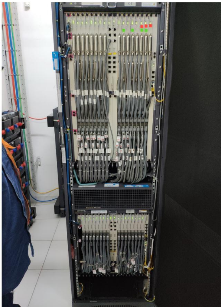
6 Estación donde llega la Fibra Óptica desde la central al Repartidor Fuente: Repartidor CNT
