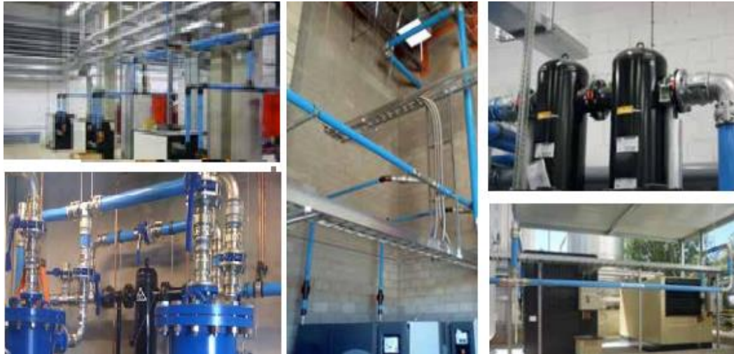
Figura 3. 1 Instalaciones del aire comprimido
