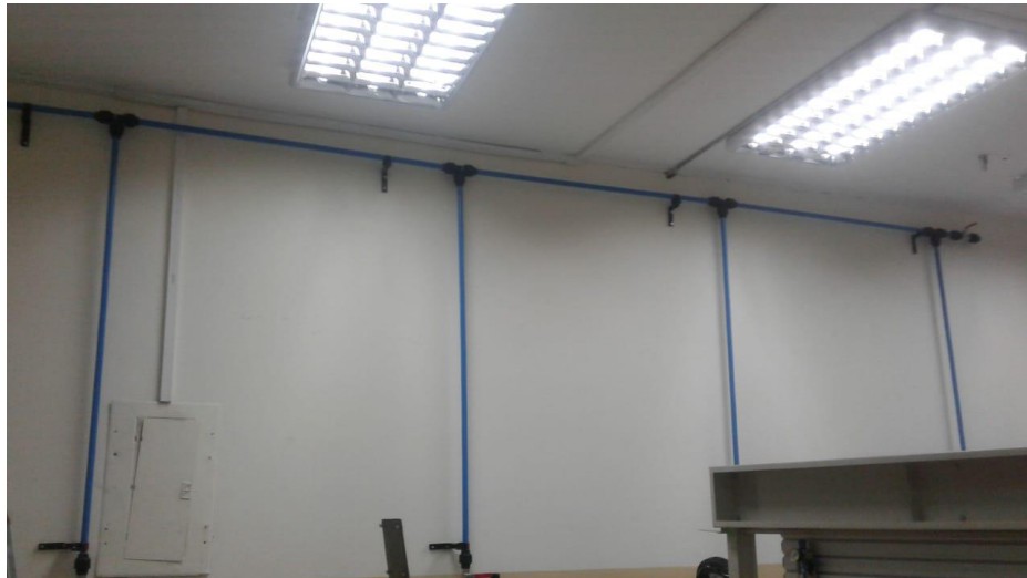
Figura 4. 7 Instalación de aire comprimido en laboratorio de Neumática de la FETD
