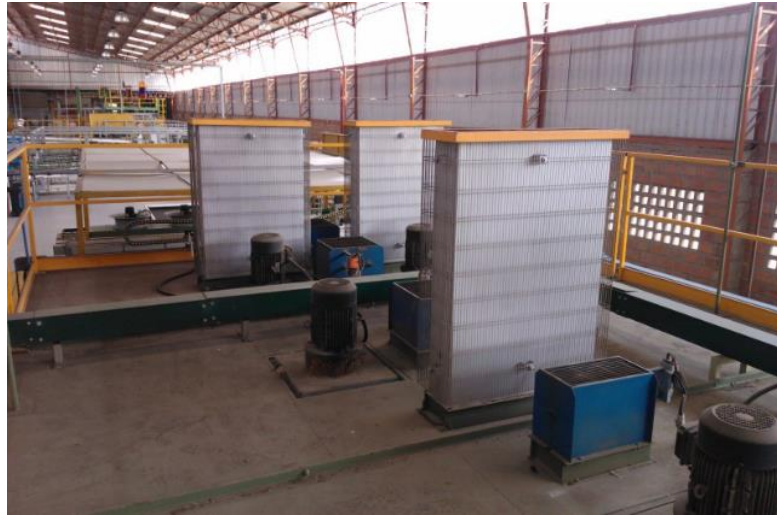
Figuras 2.2.g. Ventiladores de enfriamiento Fuente: Autor
