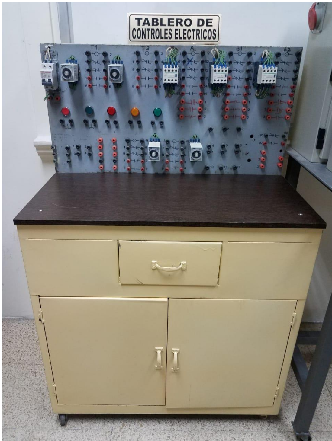
Figura 39. Tableros de controles
