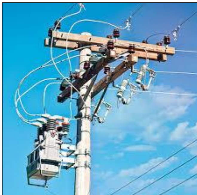
Figura 2.4: Distribución de media tensión Elaborado por: Autor.
