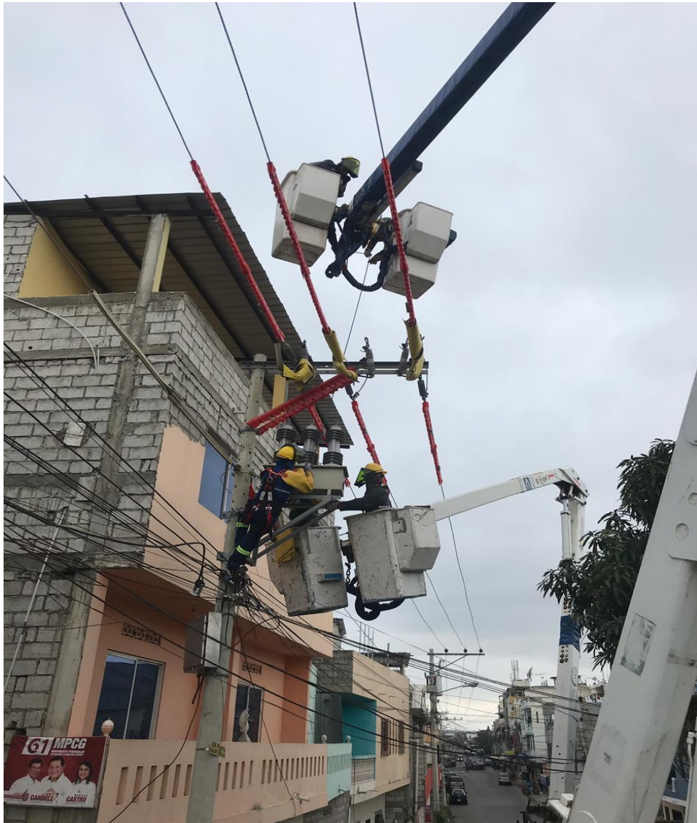
Figura 7.2: Instalación del Reconector en el alimentador libertad Elaborado por: Autor
