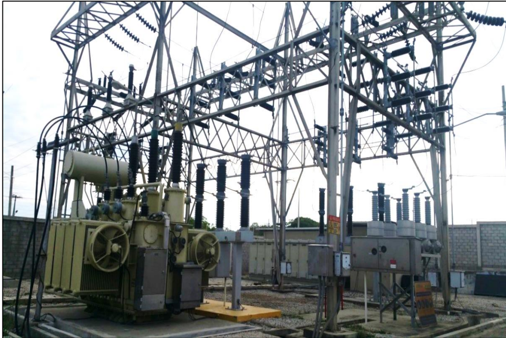
Figura 2.6: Subestación la Libertad de 69 Kv / 13.8 V Elaborado por: Autor
