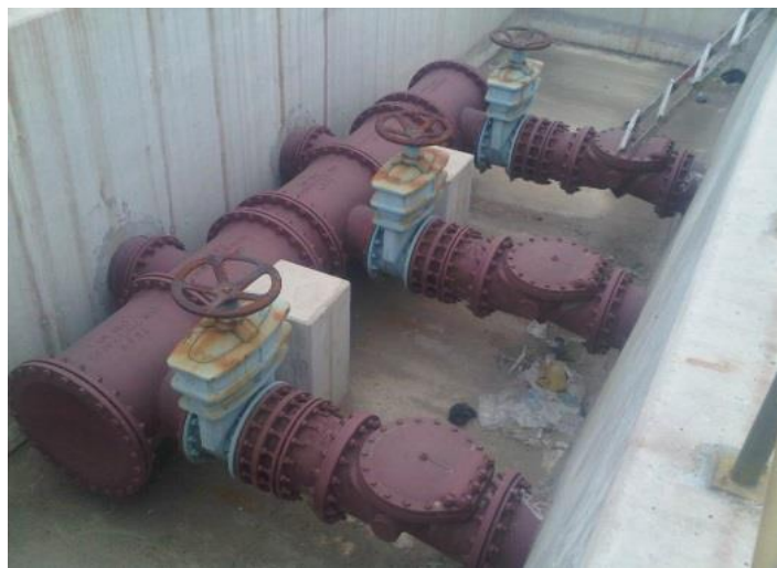
Foto 7.- Cámara de Válvulas
