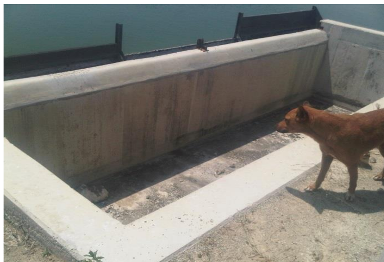
Foto 13.- Arqueta de Reboce
