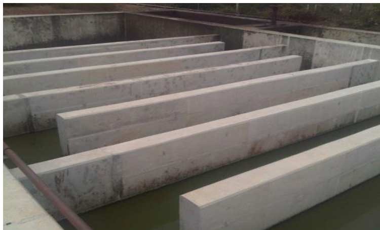
Foto 16.- Laberinto de Cloración
