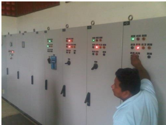
Foto 9.- Cuarto de Control
