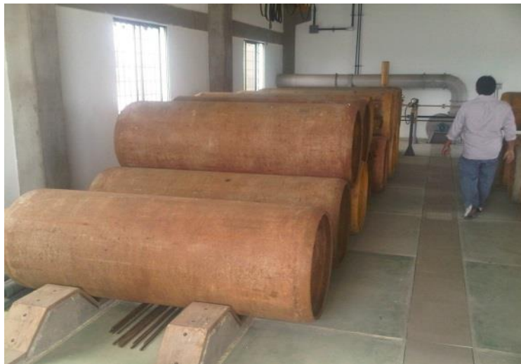
Foto 15.- Cilindros de Gas Cloro
