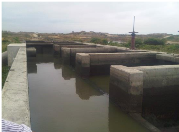
Foto 10.- Pozo de Entrada
