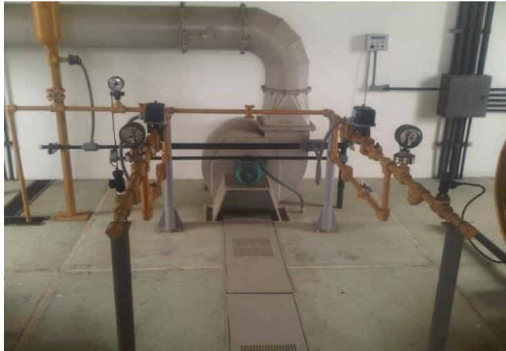
Foto 14.- Cuarto de Cloro
