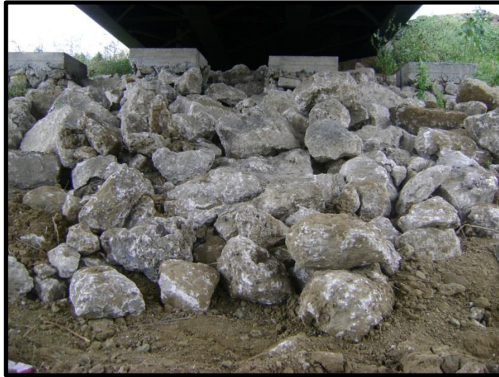
Figura 4-9 Obra de protección de estribos de la estructura sobre el río “Zapotal”.
