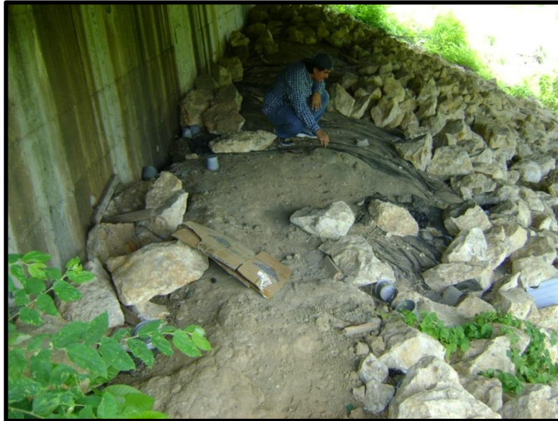
Figura 4-2 Protección de los estribos en el puente de Cerecita.
