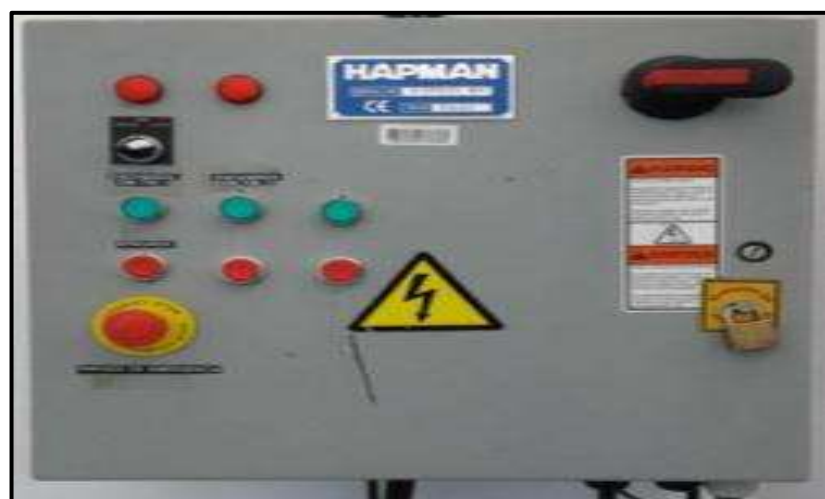
Figura 32: Panel Eléctrico Tomado de: Industrial Surindu
