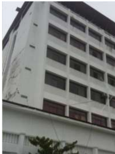
Ilustración 12 Daños en la fachada del hospital Naval (FUENTE: Ecuavisa)
