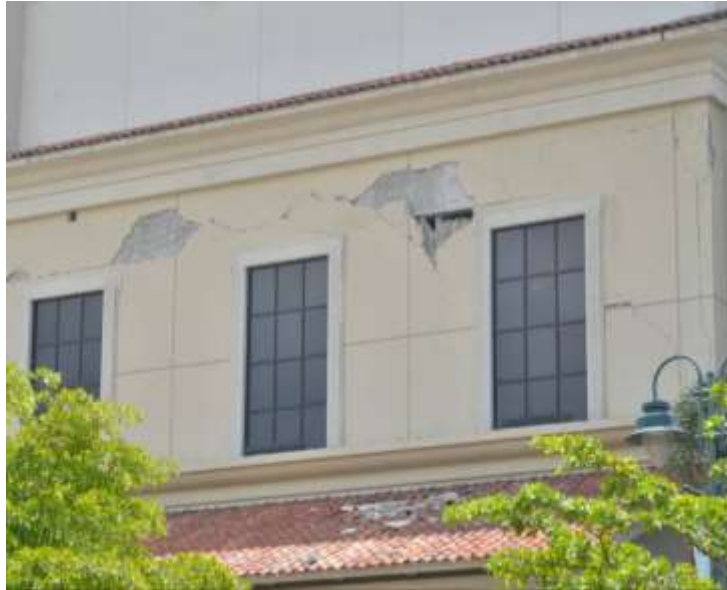
Ilustración 9 Daños en la fachada del edificio Village Plaza (FUENTE: Diario El Universo)
