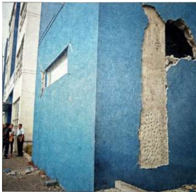
Ilustración 6 Daños en la unidad de Flagrancia de Guayaquil (FUENTE: Diario Expreso)
