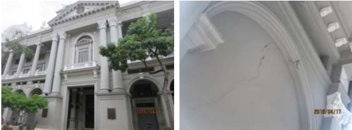
Ilustración 3 Palacio de la municipalidad de Guayaquil después del sismo del 2016.
