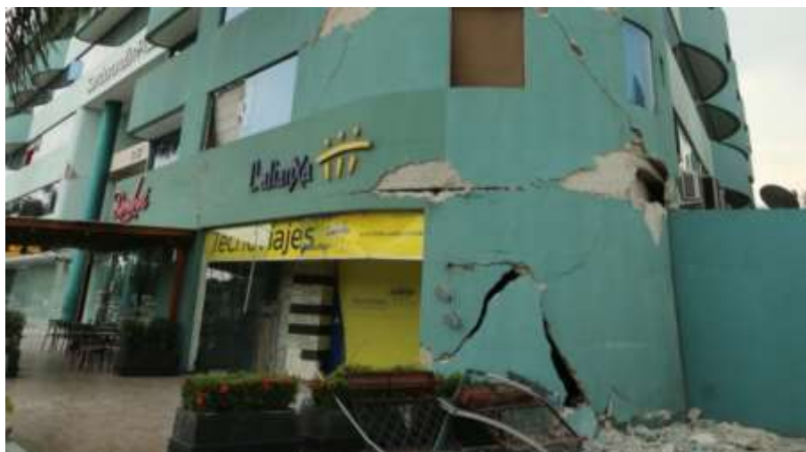
Ilustración 10 Daños en edificio Samborondón Plaza (FUENTE: Diario Expreso)
