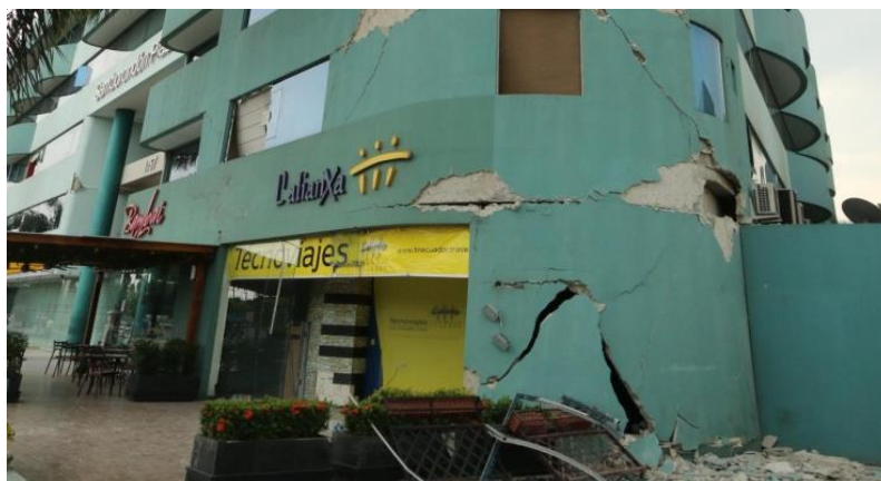
Ilustración 73. Daños en el edificio Samborondón Plaza. Fuente: (Diario Expreso, 2016)
