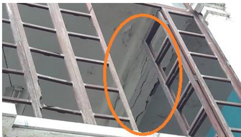
Ilustración 69. Daño en vigas. Colegio Ana Paredes de Alfaro.
