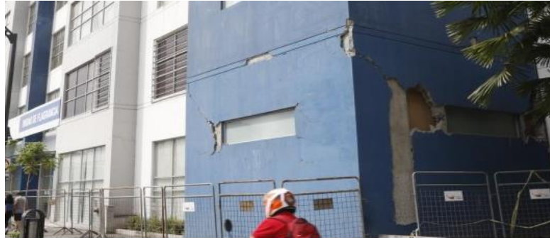
Ilustración 70. Daños en el edificio de la Unidad de Fragancia en Guayaquil. Fuente: (Diario Expreso, 2016)
