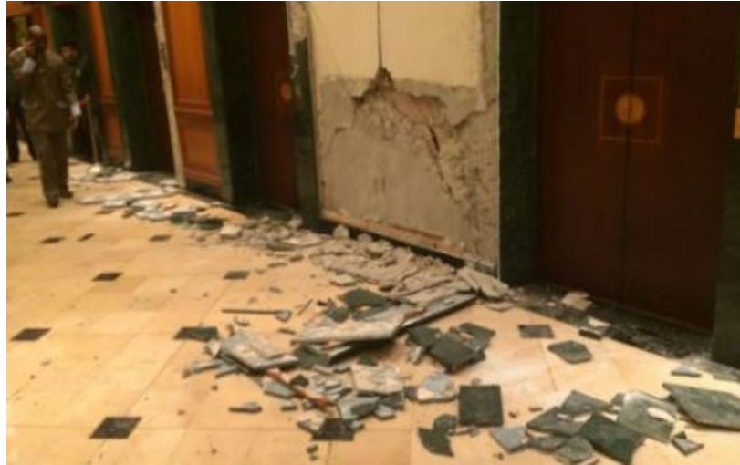
Ilustración 72. Daños registrados en las paredes del hotel Oro Verde de Guayaquil. Fuente: (Romano, 2016)
