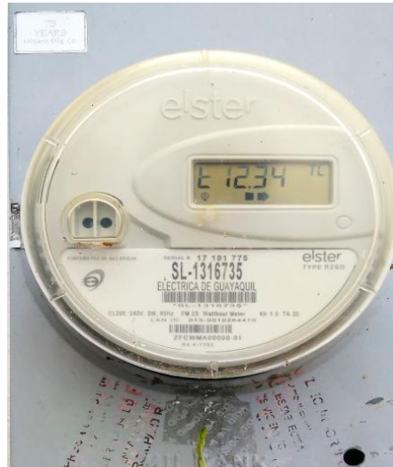
Figura: 2.21: Medidor de energía eléctrica
