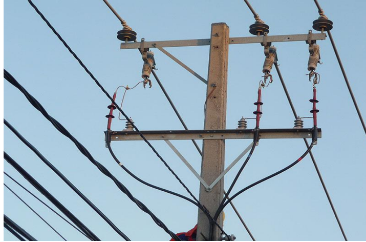
Figura 2.26: Acometida Eléctrica Fuente: (cna, 2016)
