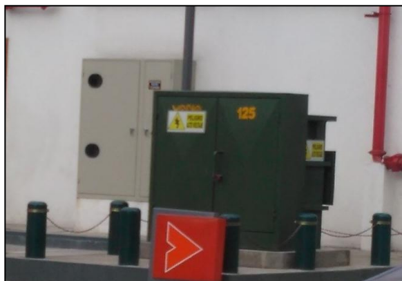
Figura 2.17: Transformador tipo pedestal
