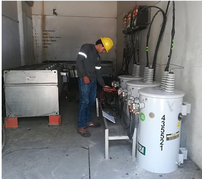
Figura 3.3: Cuarto de transformadores
