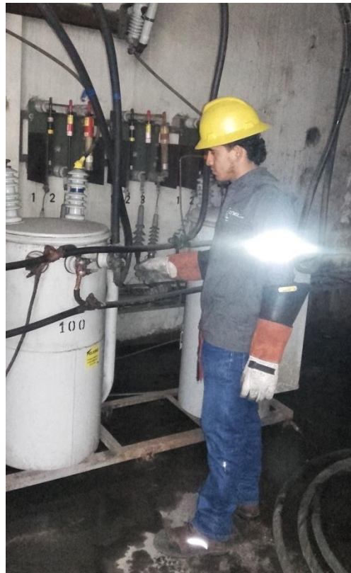
Figura 3.1: Transformador de 100 kva.
