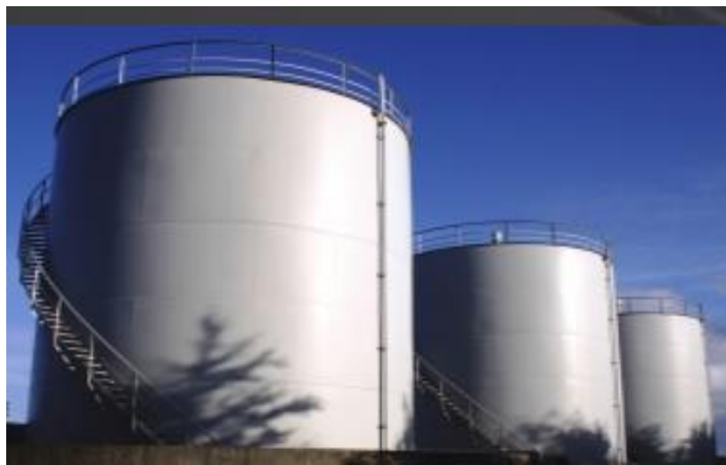
Figura 2.4 Tanques de Almacenamiento Fuente: (Petrogen, 2016)
