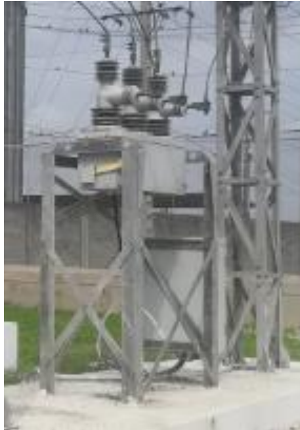
Figura 2.4: Reconectador de una subestación eléctrica Fuente: Autor
