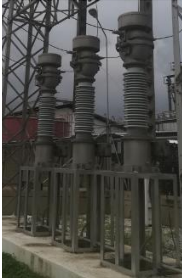
Figura 2.3: Interruptor de potencia de una subestación eléctrica Fuente: Autor
