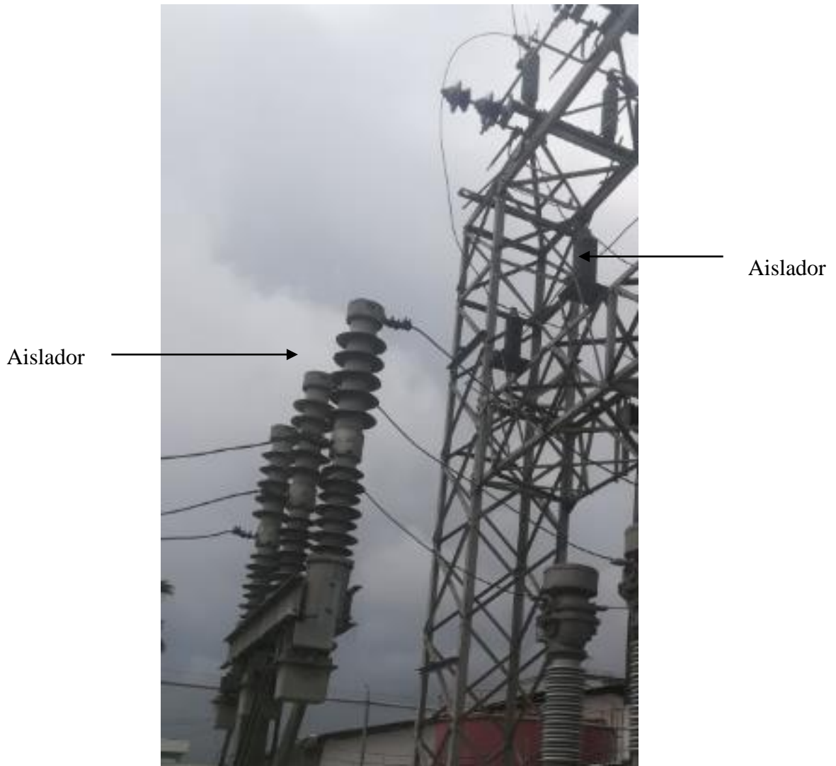
Figura 2.5: Aisladores de una subestación eléctrica Fuente: Autor
