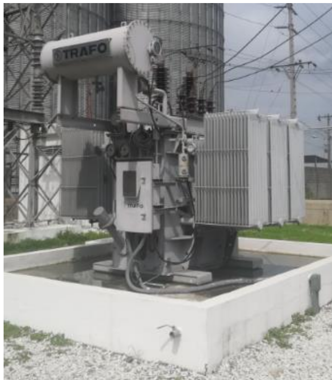
Figura 2.2: Transformador de una subestación eléctrica Fuente: Autor
