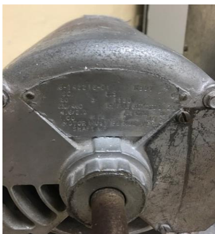
Figura 27: Placa del motor Tomada de: Autor
