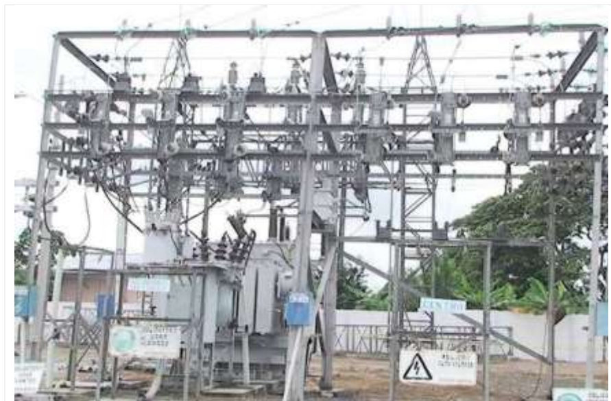
Figura 2.11: Subestación en Quinindé
