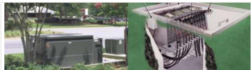
Figura 2.16: Interruptor de distribución subterráneo tipo vista 15 KV
