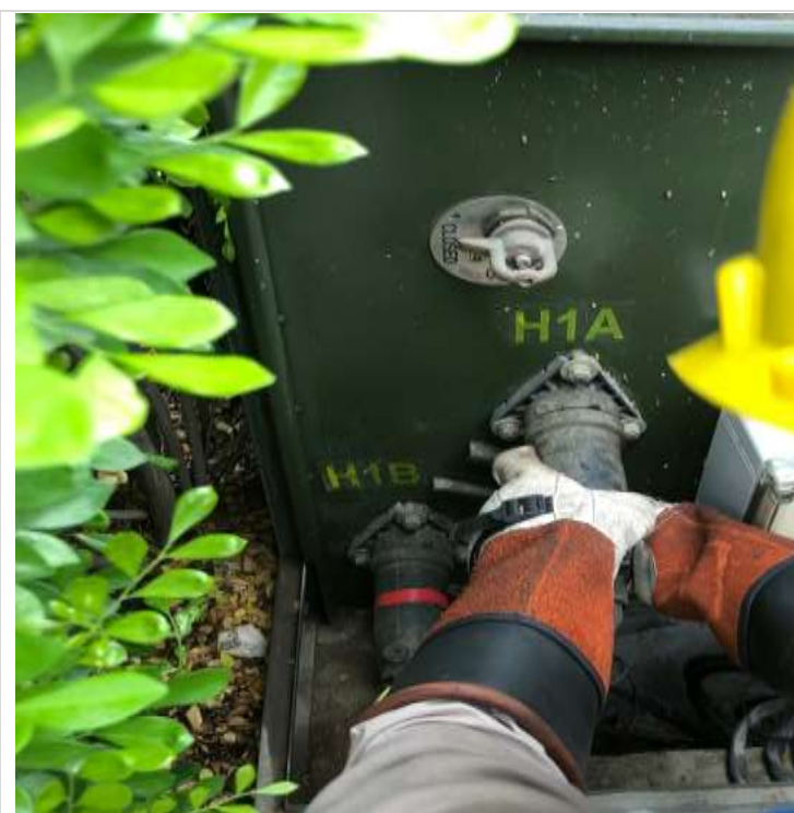
Figura 4.9: Conexión invertida de entrada H1A y salida H1B. Fuente: Autor
