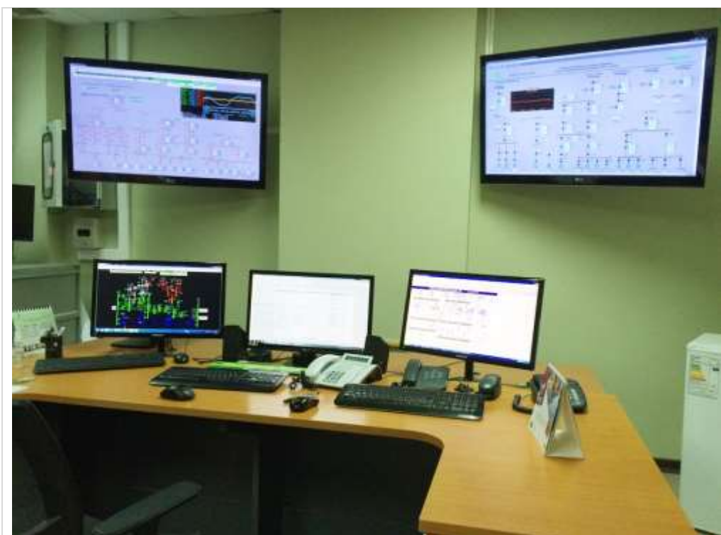
Figura 4.19: Centro de operación del sistema SCADA.
