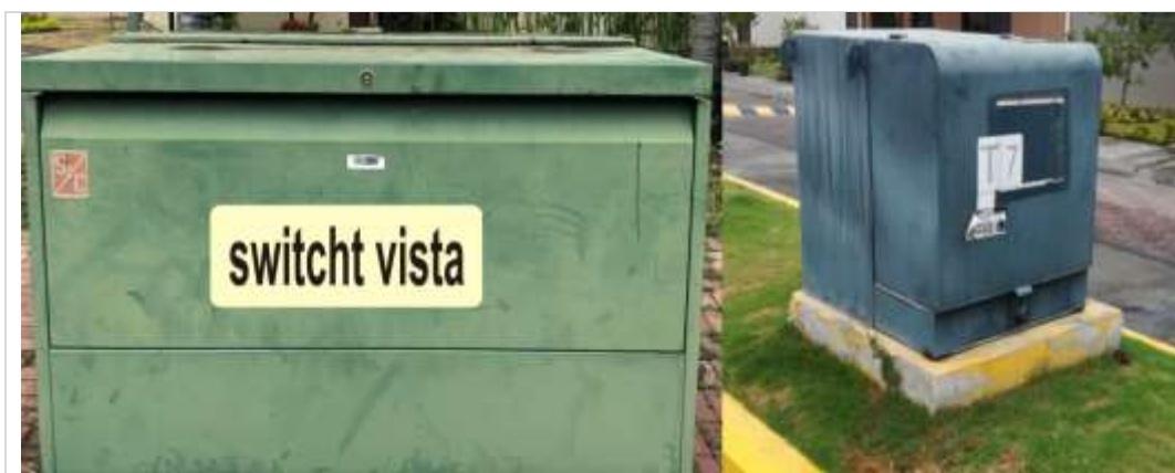
Figura 3.2: Switch vista tipo pedestal y Transformador Pad Mounted.
