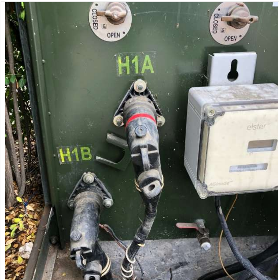
Figura 4.14 Maniobras de codo conector 15 KV
