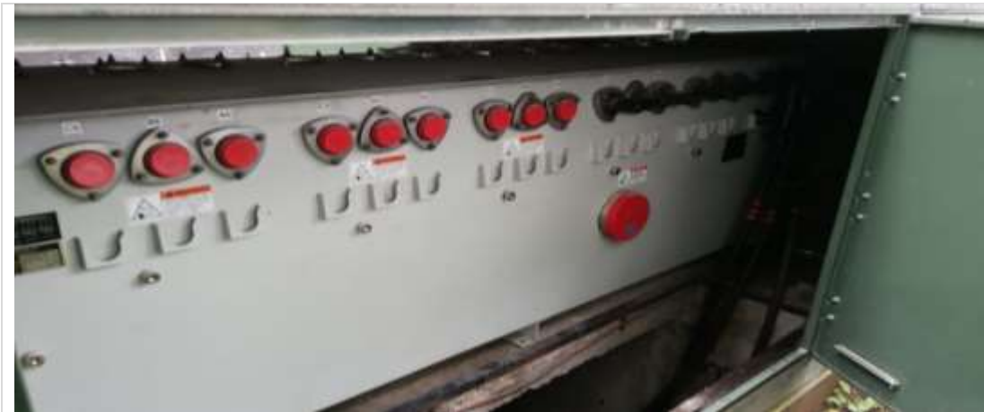
Figura 4.3 Entrada y salida del switch vista
