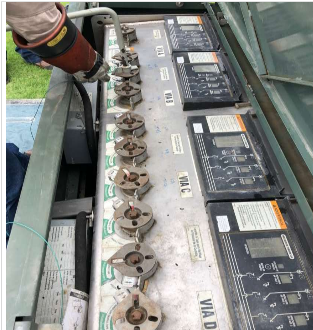
Figura 4.18: Maniobra manual del sistema actual en el switchgear
