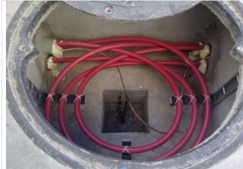
Figura 2.15: Caja de paso
