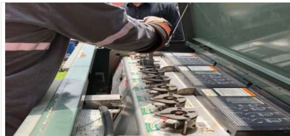
Figura 4.13: Maniobra del sistema actual en el switchgear
