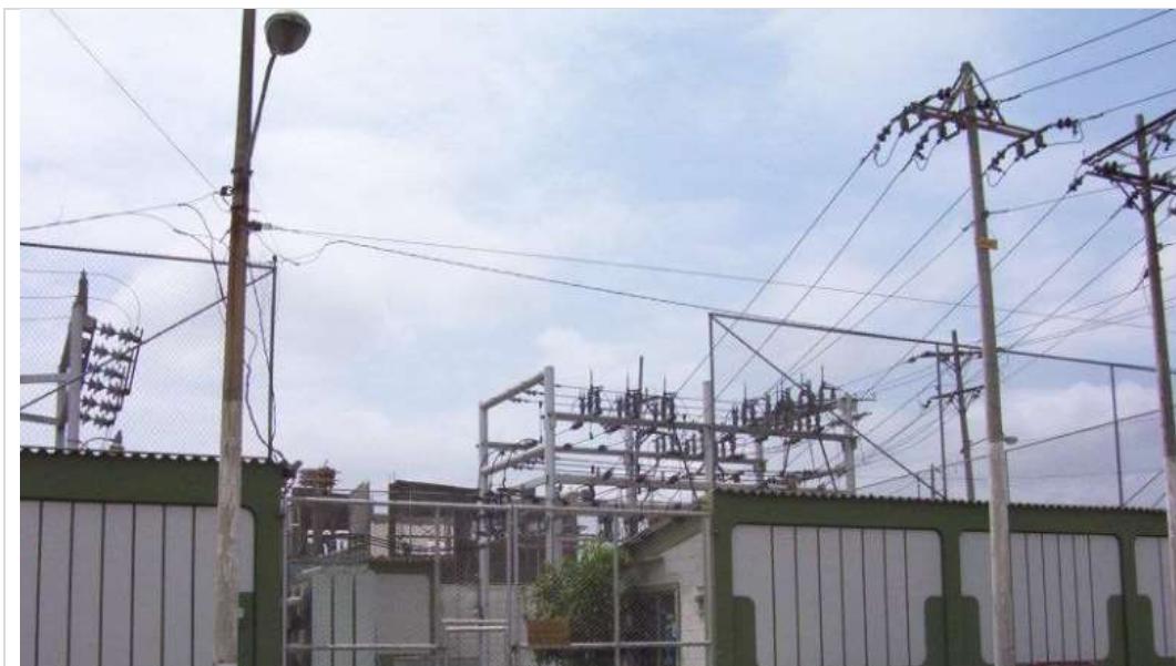
Figura 2.12: Alimentador principal trifásicos y monofásicos, Área de distribución suburbana.
