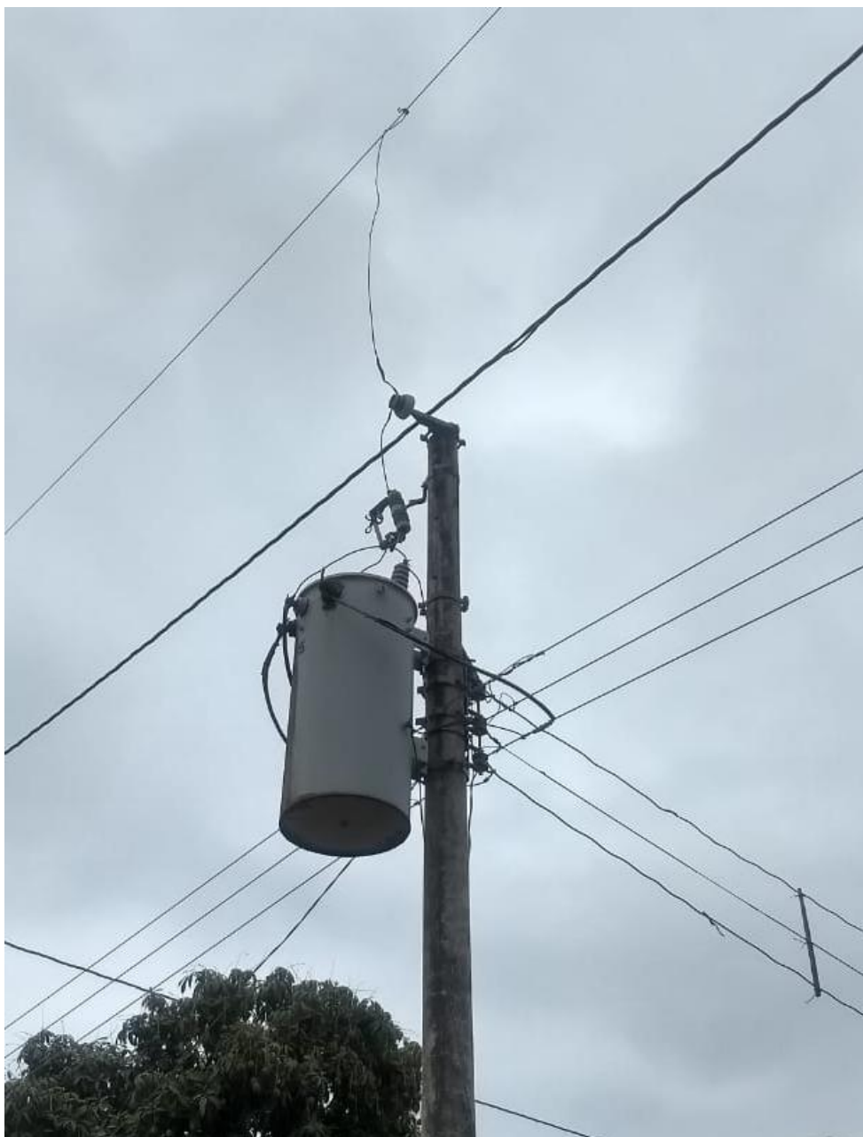
Figura 3. 6. Transformador de la manzana #14
