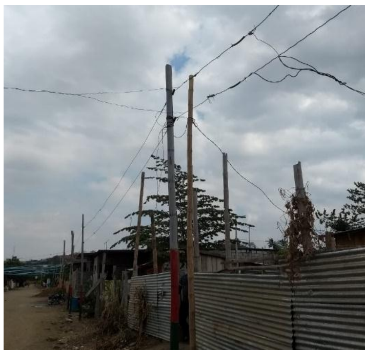
Figura 3. 3. Instalaciones eléctricas de la manzana #14
