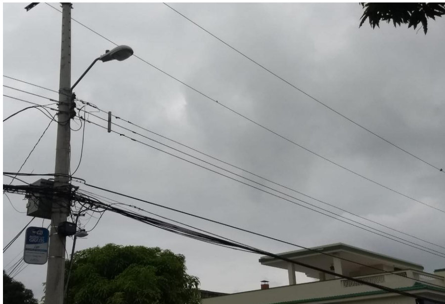
Figura 2. 17. Red de distribución tipo aérea
