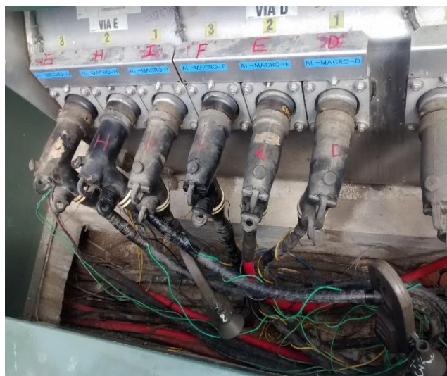
Figura 2. 7. Red de distribución subterránea en media tensión
