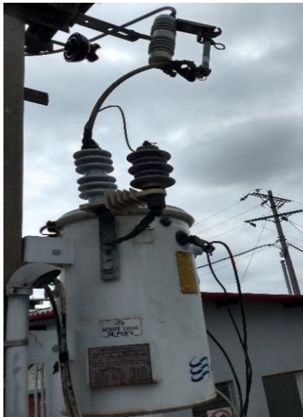
Figura 2. 28. Transformador de distribución monofásica
