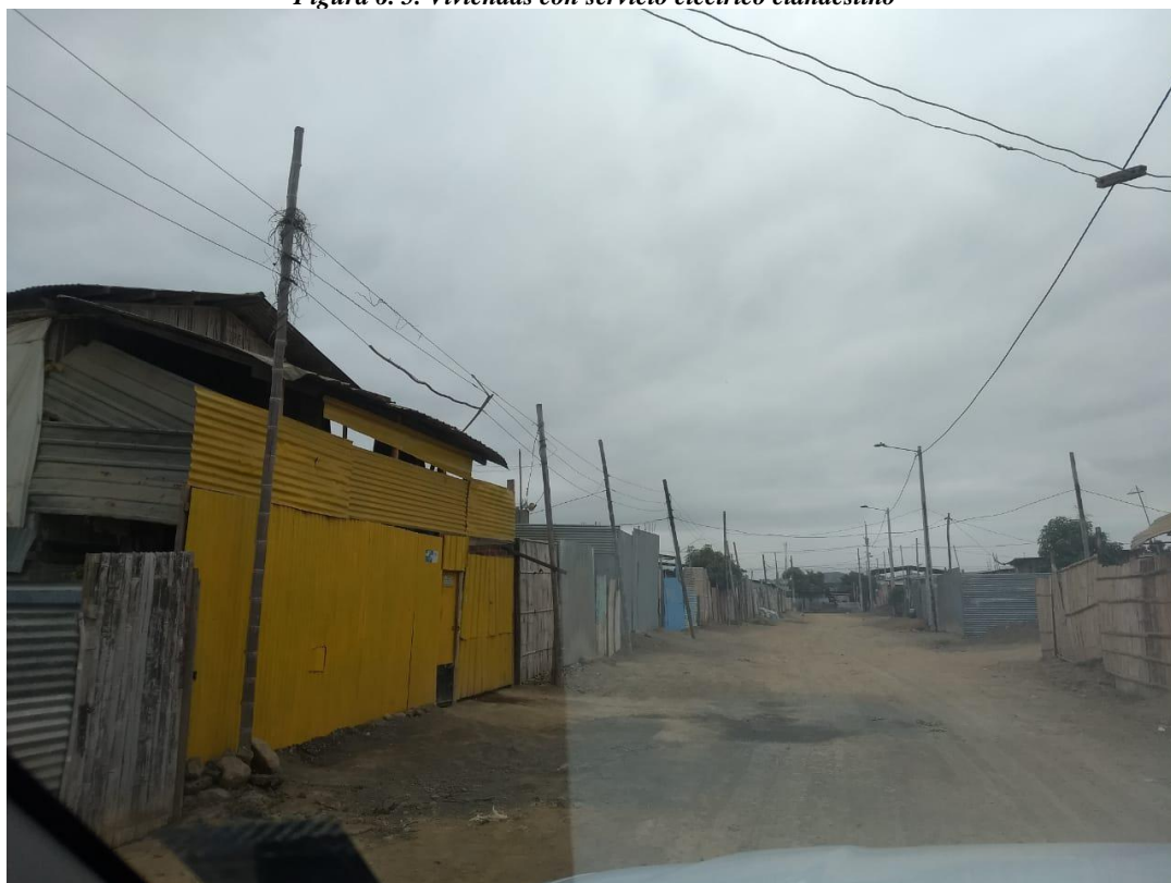
Figura 6. 5. Viviendas con servicio eléctrico clandestino
