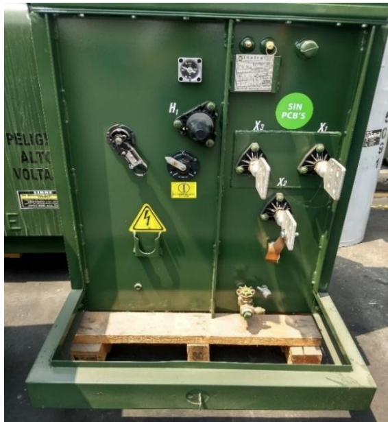
Figura 2. 31. Transformador tipo radial
