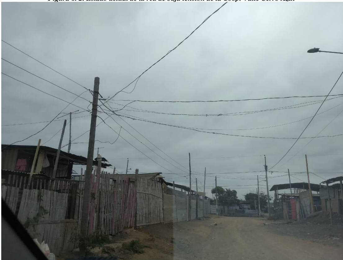
Figura 6. 2. Estado actual de la red de baja tensión de la Coop. Valle Cerro Azul
