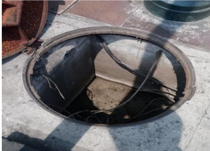
Figura 2. 16. Red de distribución tipo subterráneo Fuente: https://bit.ly/2SCGxWe
