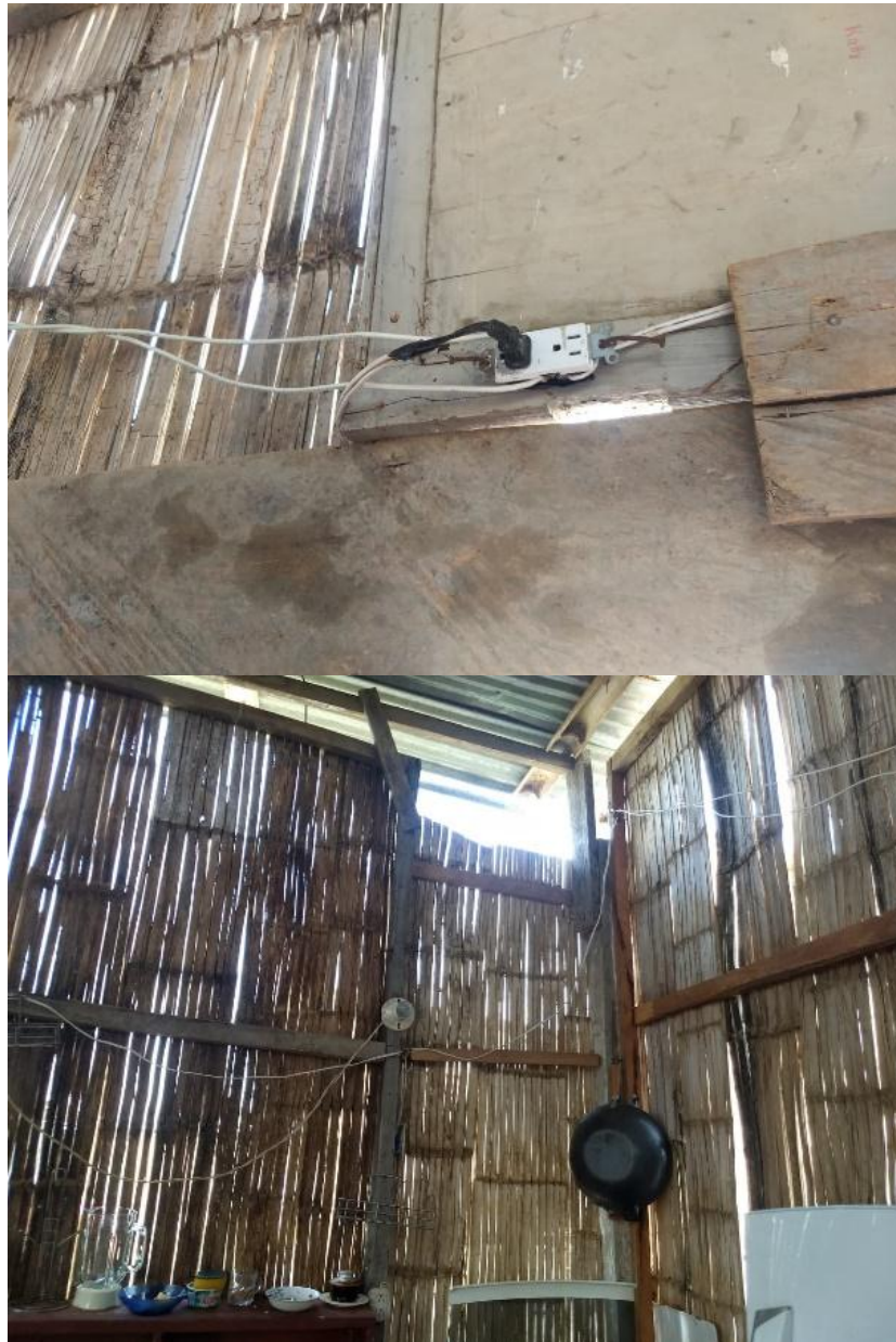
Figura 3. 8. Instalaciones internas de la manzana #14 Sl.8
