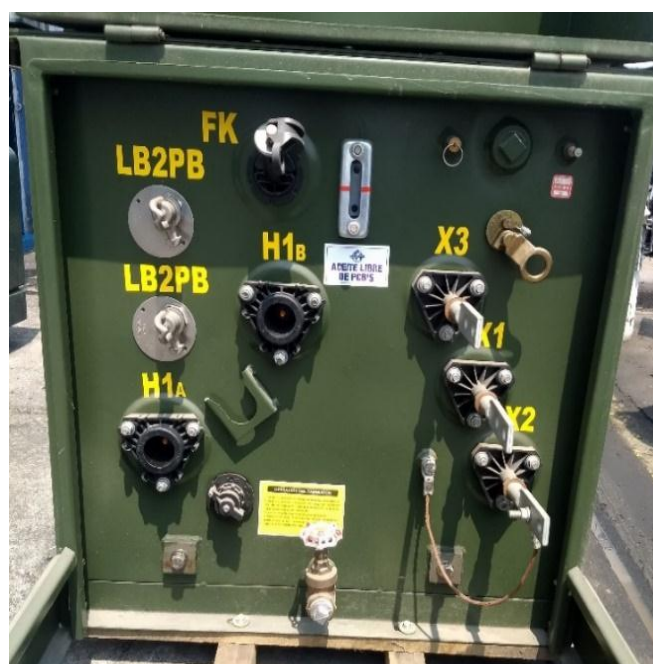
Figura 2. 32. Transformador tipo malla
