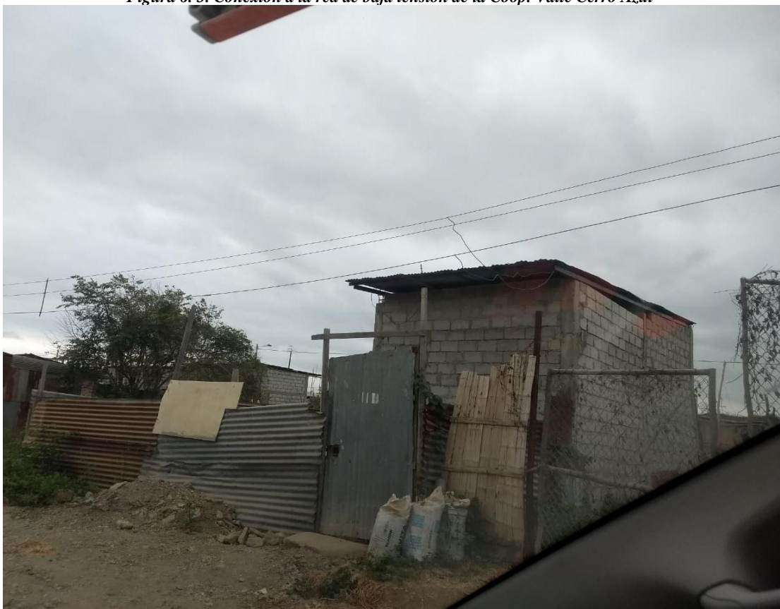
Figura 6. 3. Conexión a la red de baja tensión de la Coop. Valle Cerro Azul
