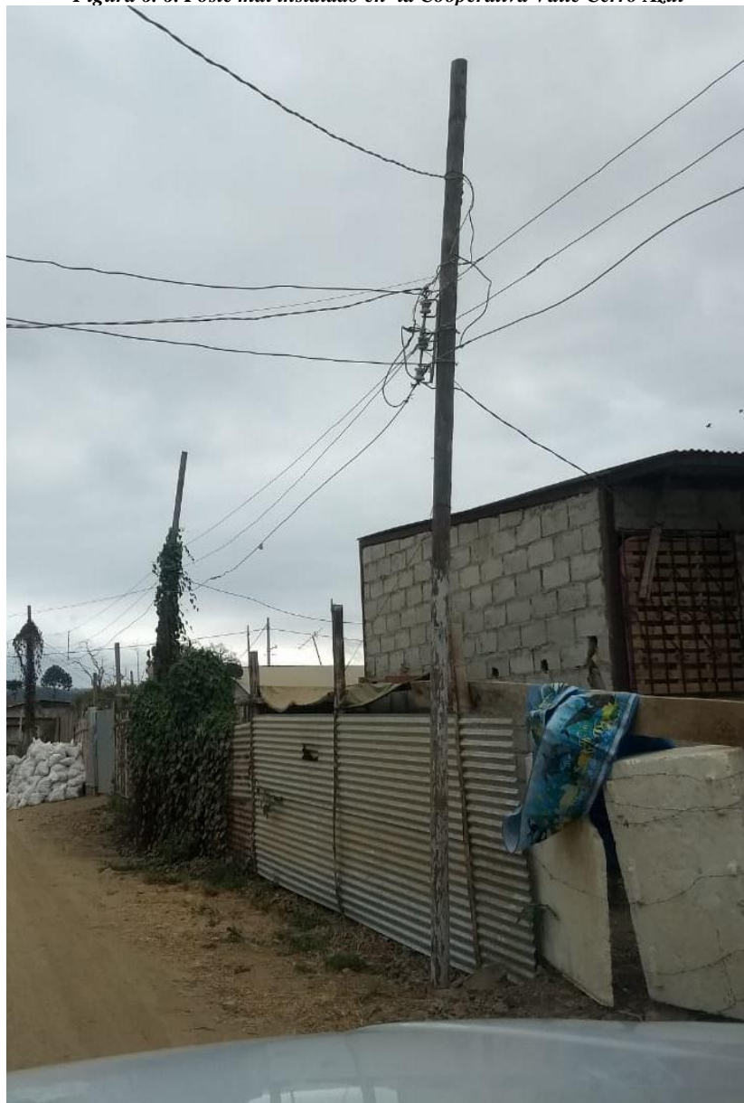
Figura 6. 6. Poste mal instalado en la Cooperativa Valle Cerro Azul
