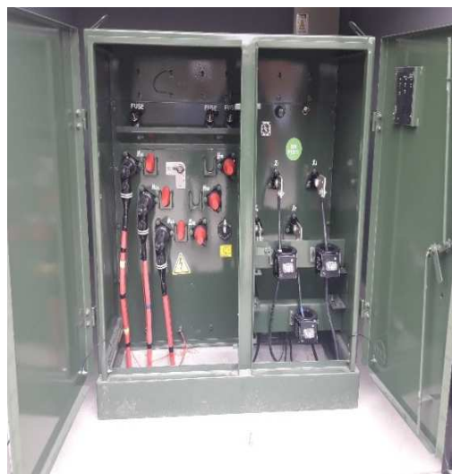
Figura 2.7 Transformador padmounted Fuente: El autor
