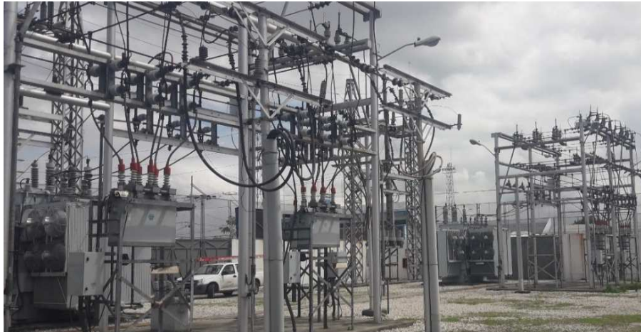
Figura 3.4 Subestación Pradera Fuente: El autor
