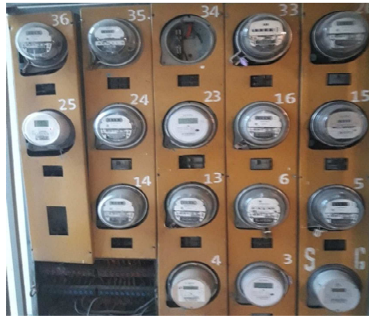
Figura 2.15 Tablero medición Fuente: El autor
