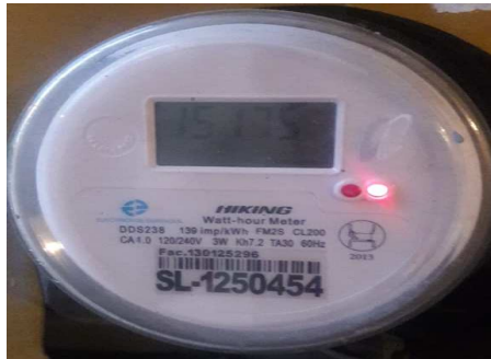
Figura 2.18 Medidor monofásico Fuente: El autor
