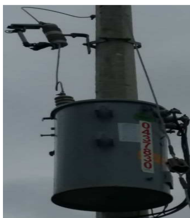
Figura 2.5 Transformador convencional Fuente: El autor
