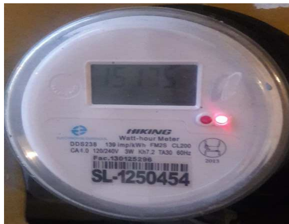
Figura 2.17 Medidor electrónico Fuente: El autor
