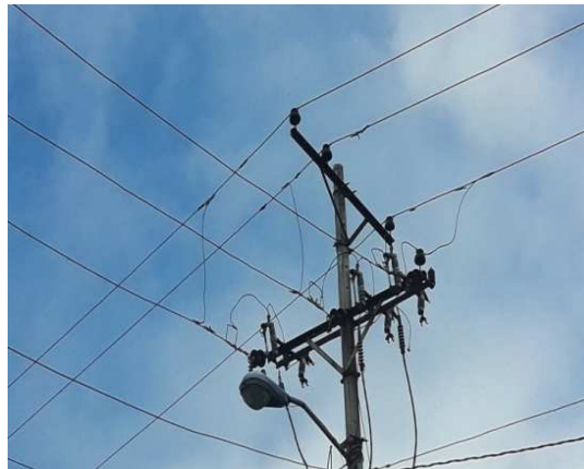
Figura 2.9 Línea de media tensión 13.8kv Fuente: El autor
