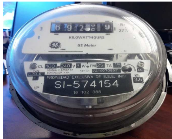
Figura 2.16 Medidor mecánico Fuente: El autor
