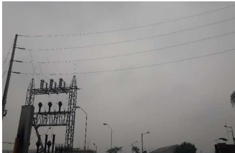
Figura 2.8 Línea de alta tension 69kv
