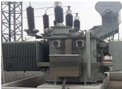
Figura 2.4 Transformador de poder o potencia Fuente: El autor
