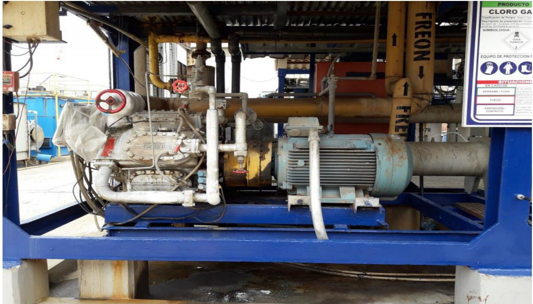
Figura 4.8: Compresor sabroe de freón. Fuente: Planta de productos químicos
