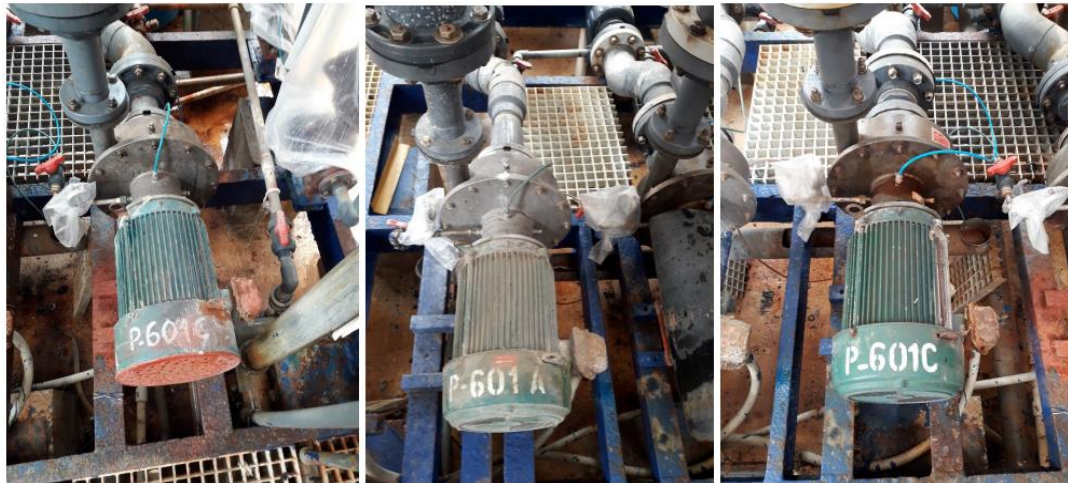
Figura 4.6: Bombas del proceso de hipoclorito. Fuente: (Planta, 2018)
