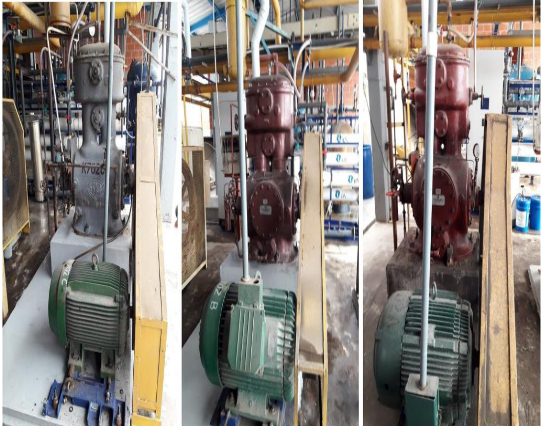
Figura 4.12: Compresores para amoniaco. Fuente: (Planta, 2018)
