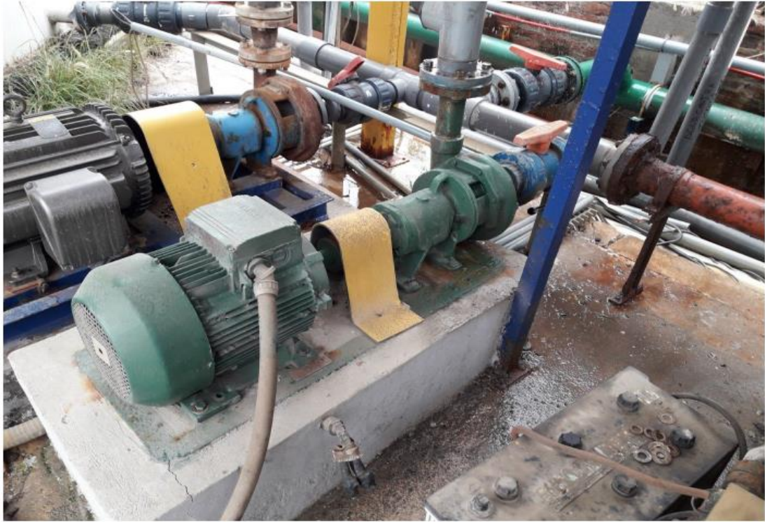
Figura 4.11: Bombas para agua bruta. Fuente: (Planta, 2018)
