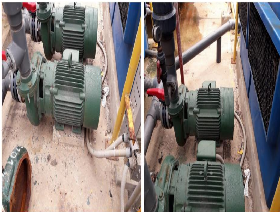
Figura 4.10: Bombas para agua de enfriamiento. Fuente (Planta, 2018):
