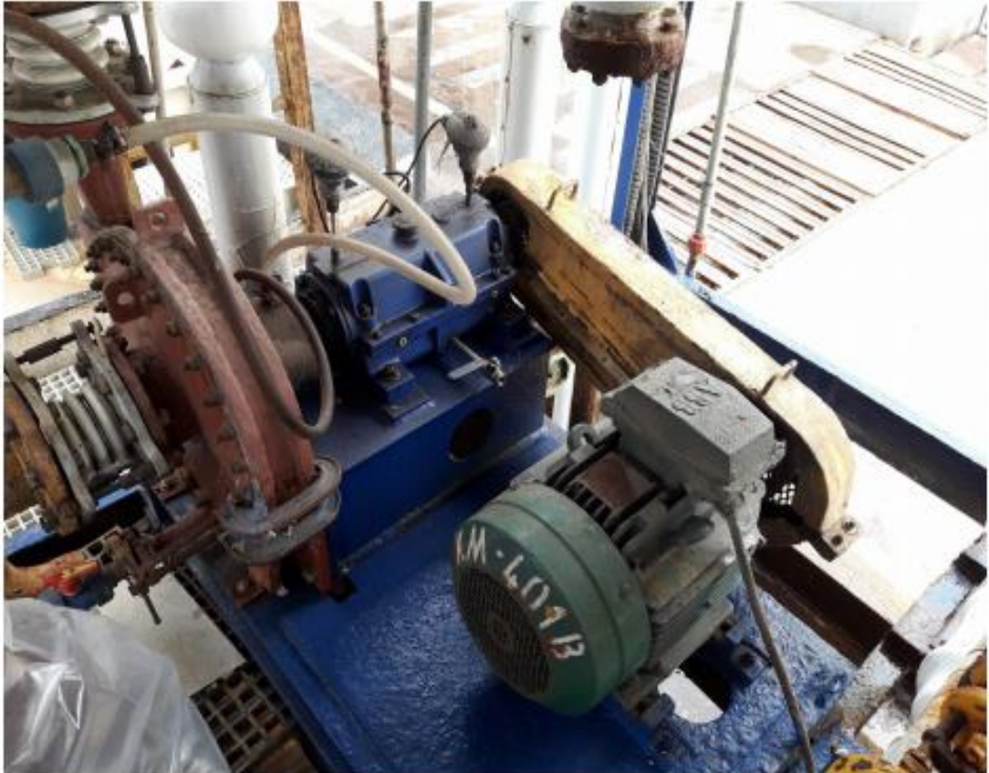
Figura 4.9: Soplador de cloro. Fuente: (Planta, 2018)
