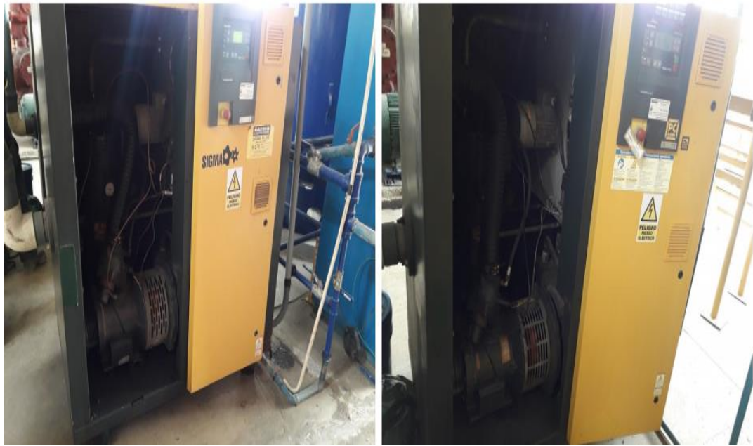
Figura 4.13: Compresores para aire comprimido. Fuente: (Planta, 2018)
