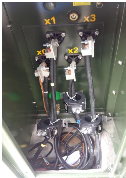
Figura 3. 1: TC's de rango extendido instalados
