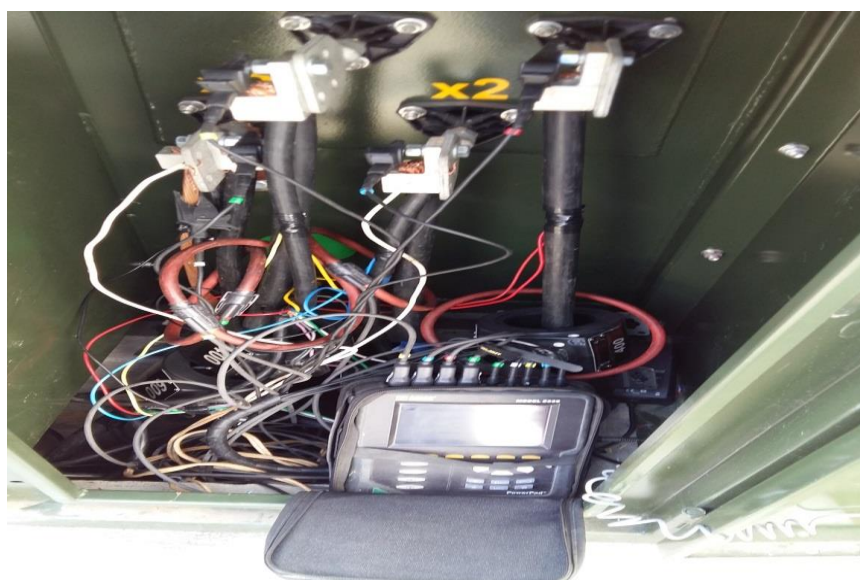
Figura 3. 14: Equipo Power Pad modelo 8335 instalado y registrando consumo
