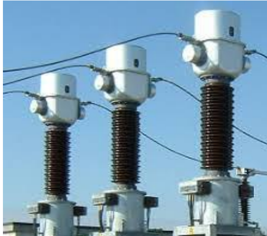
Figura 2. 6: Transformadores de medida Fuente: (Mecafenix, 2018)
