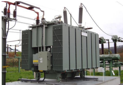
Figura 2. 5: Transformador de potencia Fuente: (Gate, 2017)
