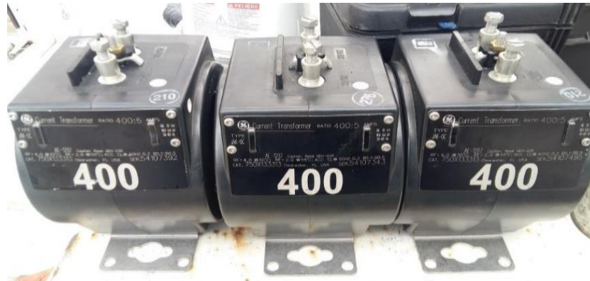
Figura 3. 3: Transformadores de corriente rango discreto 400:5 a instalarse.
