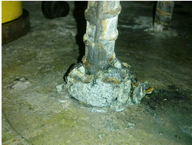
Figura # 36 desprendimiento del mortero de azufre del tubo de postensado introducido en el dado de hormigón
