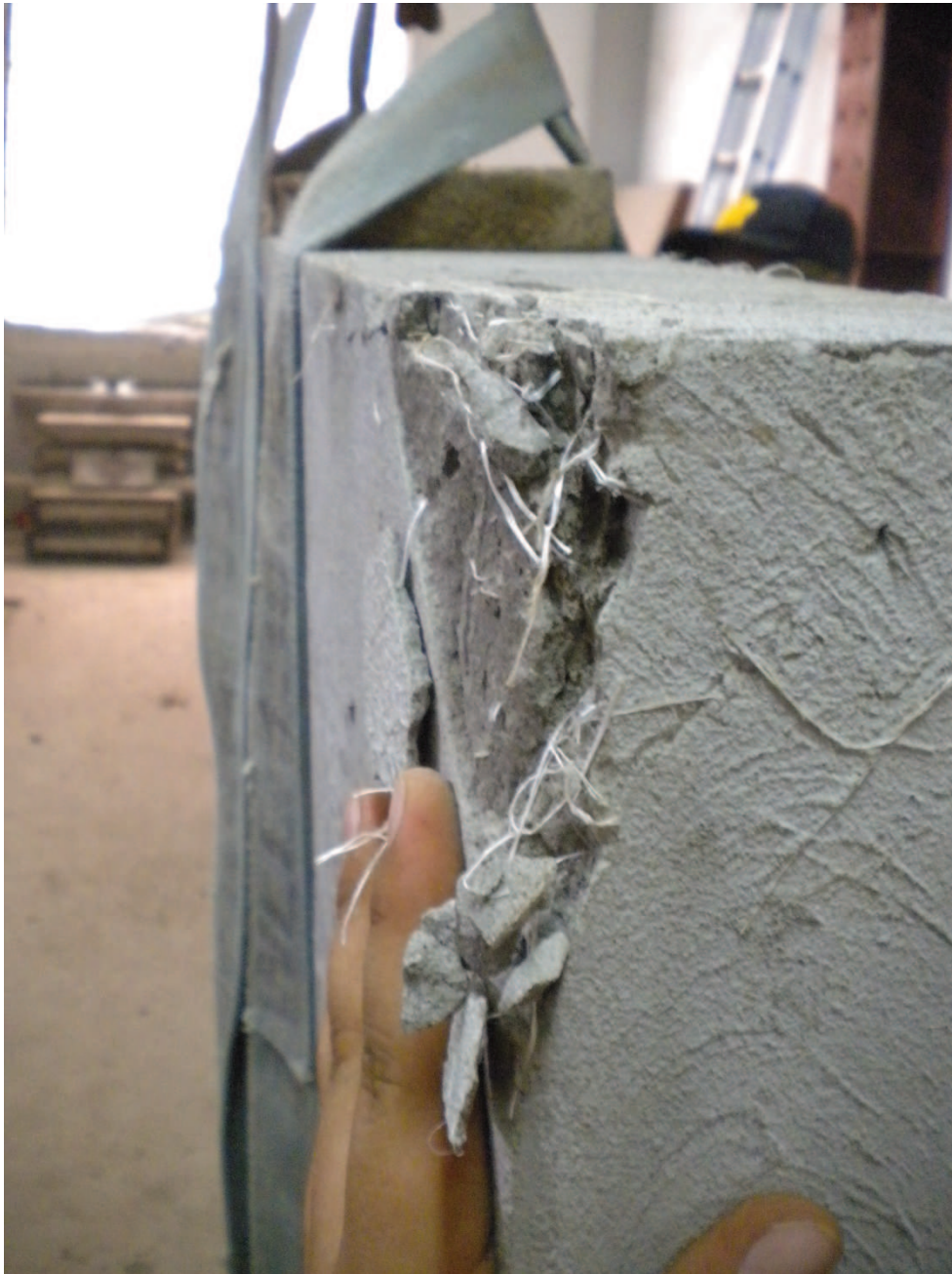
Foto 17. Falla de primera capa de enlucido por ubicación de base metálica, sin comprometer estructura principal de la pared.
