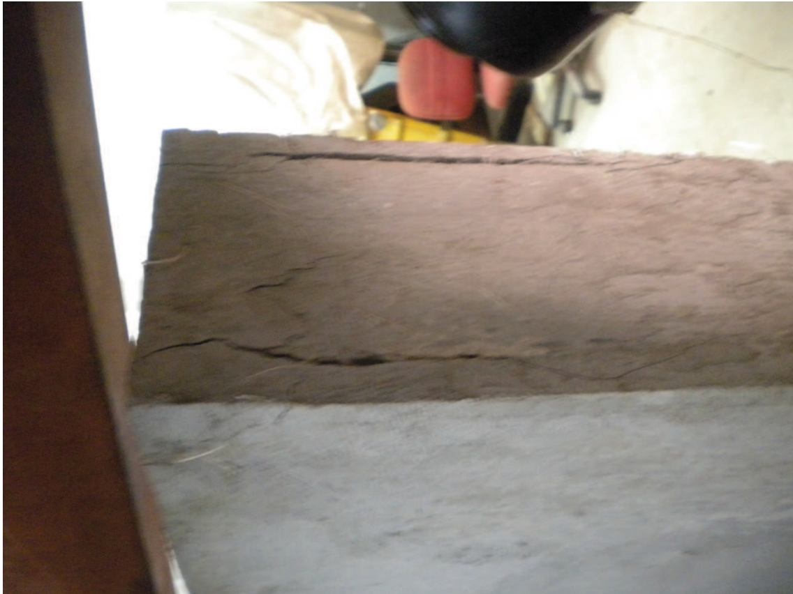
Foto 13. Falla que se noto en una parte del enlucido pero que no afecto a la estructura de la pared.
