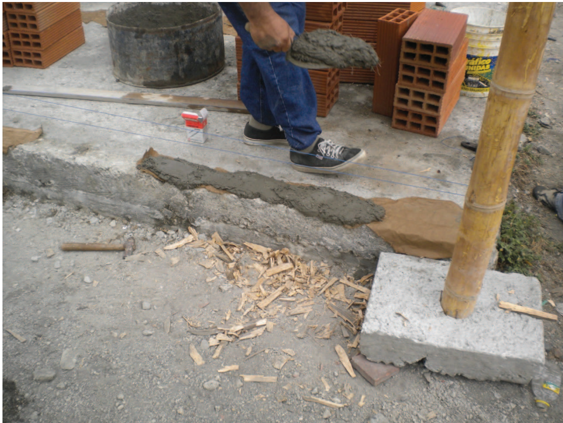
Foto 5. Se utiliza el mismo saco de cemento para poder despegar las paredes para las pruebas.
