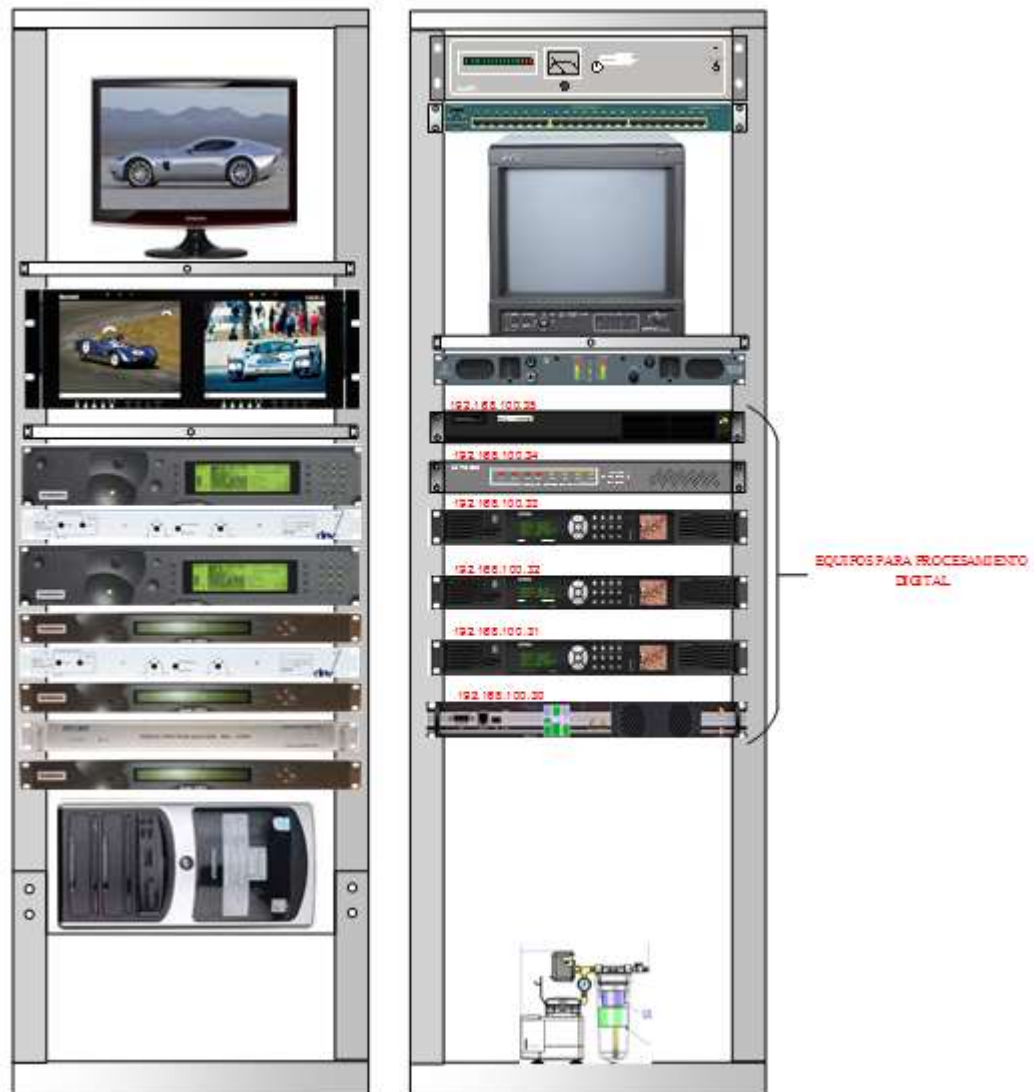
Figura 3. 2: Equipos que componen el Telepuerto Elaborado por: Autor.
